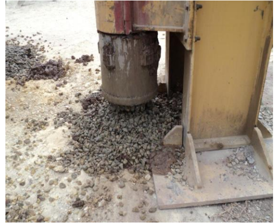
Fotografía No. 5.3.10: Agregado empleado para las pilas. Nótese el balde y el volumen de material que descarga para configurar una sección de pila de 30cm de altura.
