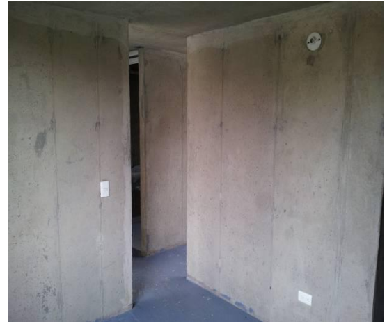
Fotografía No. 5.3.6: Sistema estructural de las torres, muros portantes en concreto reforzado, propios del sistema outinord.
