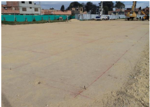
Fotografía No. 5.3.7: Zona Z. Capa de relleno granular y cimbrado para la localización de las pilas de agregado compacto.
