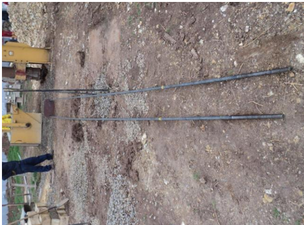
Fotografía No. 5.3.15: Sistema de barras a tensión que abarca toda la longitud de la pila y la longitud de traslape para su integración con el refuerzo principal de la losa de piso.
