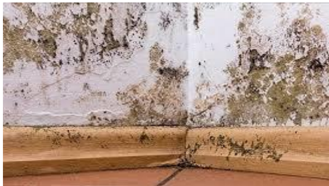
Ilustración 1. Daños estéticos por humedad, acumulación de hongos. Tomado de www.mister.hogar.com
