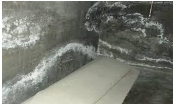
Ilustración 4. Daños estéticos por humedad, Eflorescencia en el concreto. Tomado de http://www.toxement.com.co/media/3396/eflorescencias_concreto.pdf .
