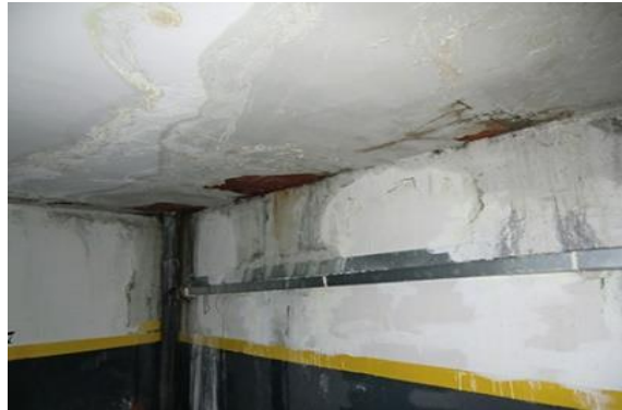
Ilustración 5. Daños estéticos y estructurales por humedad, filtraciones en el concreto en sótanos. Tomado de https://www.preasa.com/eliminacion-y-reparacion-de-filtraciones-de-agua-en-edificios .
