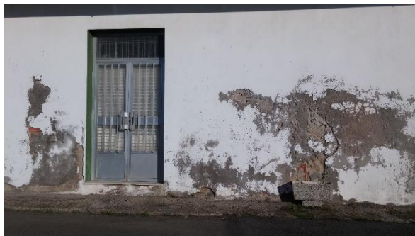
Ilustración 7. Daños en fachada por humedad, humedad capilar, se presencia como asciende la humedad. Tomado de https://antihumedades.es/blog/aprende-a-reconocer-una-humedad-por-capilaridad-ascendente/
