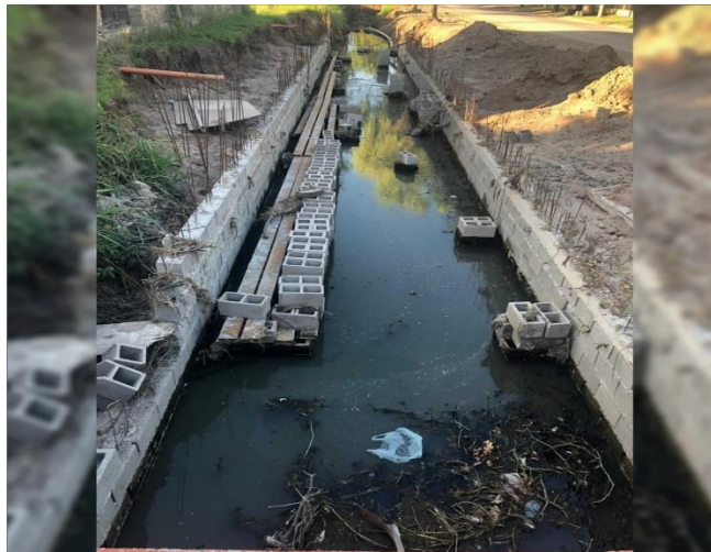
Ilustración 8. Humedad de obra, se presencia los estancamientos de agua. Tomado de https://el-periodico.com.ar/contenido/95191/preocupa-el-agua-estancada-en-una-obra-por-primeros-colonizadores
