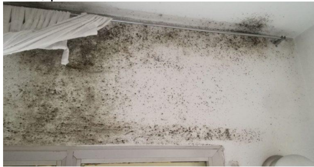
Ilustración 10. Condensación, falta de ventilación y acumulación de hongos. Tomado de https://antihumedades.es/blog/ .
