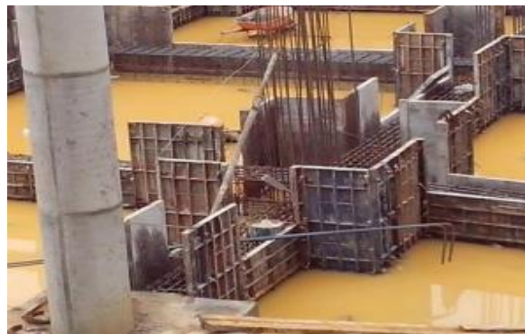
Ilustración 9. Humedad de obra, inundación en obra por falta de drenaje en obra. Tomado de http://noesis.uis.edu.co/bitstream/ .
