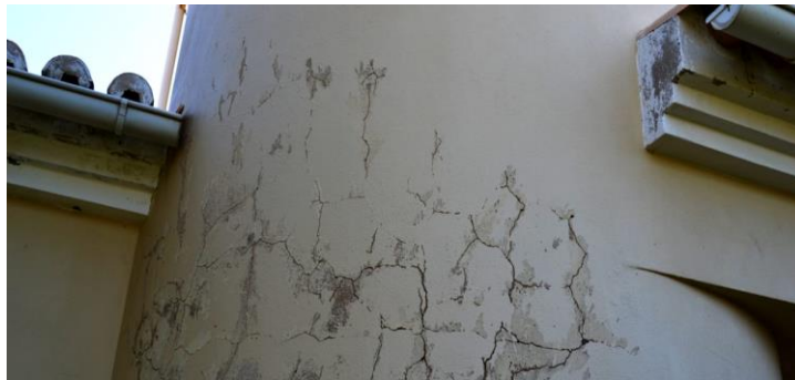
Ilustración 2. Daños estéticos por humedad, grietas en fachadas por causa de la humedad. Tomado de https://www.homify.com.ve/
