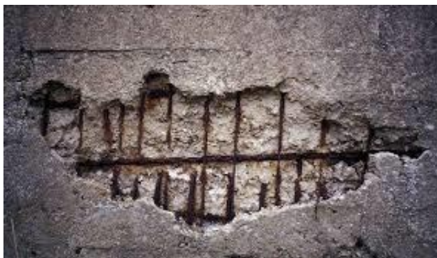
Ilustración 6. Erosión en el concreto. Tomado de https://www.preasa.com/eliminacion-y-reparacion-de-filtraciones-de-agua-en-edificios .
