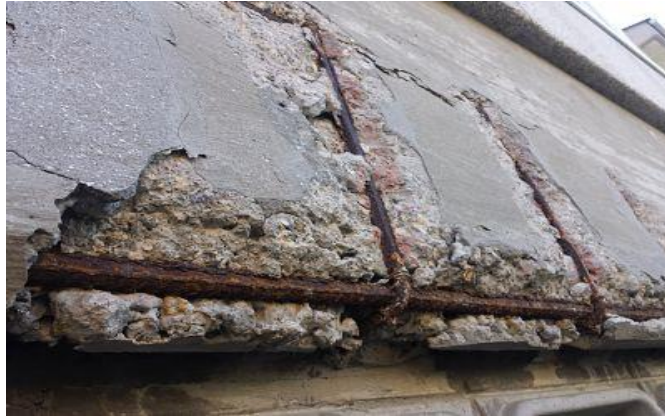
Ilustración 3. Daños estructurales por humedad, refuerzo expuesto por bajo recubrimiento. Tomado de http://humeingenieria.es -
