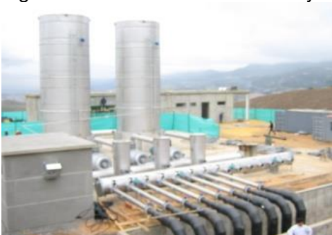
Figura 3-7 Planta de Tratamiento y Aprovechamiento de Biogás – RSDJ
