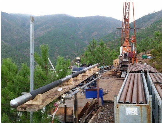
Imagen 87. Equipo para ejecución de fractura hidráulica.
