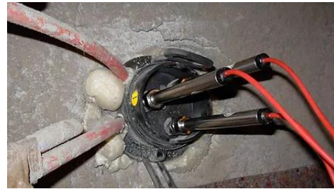
Imagen 114. Extensómetro de Varilla para controlar los desplazamientos a distinta profundidad.
