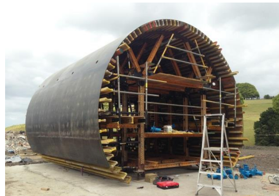
Imagen 109. Carro de encofrado utilizado para el tnel de la Autopista del Pacfico en Ballina, Australia.
