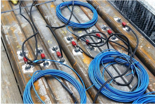
Ilustración 115. Extensómetros en arcos metálicos Fuente: https://tinyurl.com/2p8k56e4
