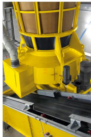
Ilustración 61. Descarga de masa de ladrillo silico-calcáreo por debajo de la mezcladora (masa, 2022)
