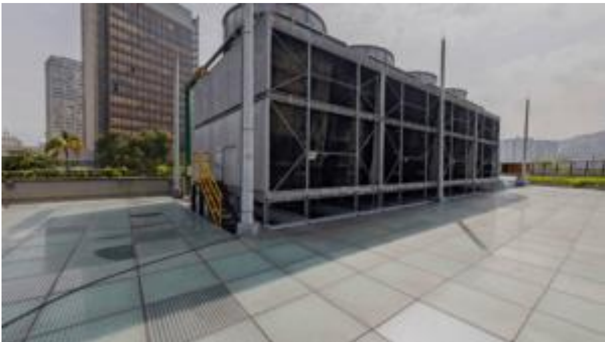
Ilustración 8 Torres de enfriamiento - Distrito térmico de alpujarra, Medellín-Colombia Fuente: EPM y Distritos térmicos en las ciudades – Recorrido virtual
