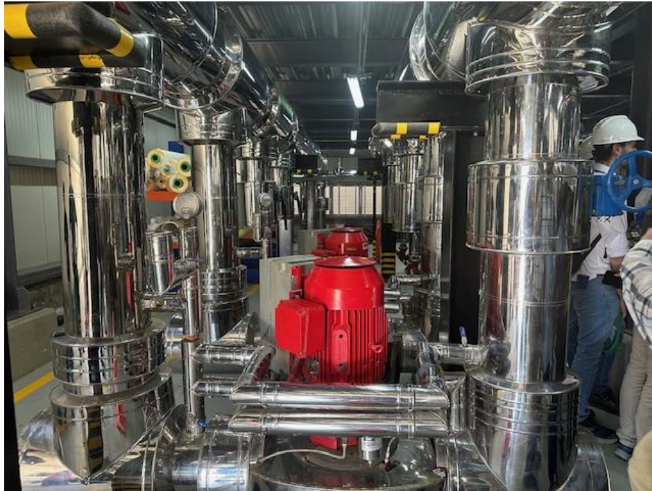
Ilustración 15 Cuarto de bombas, Cartagena-Colombia
