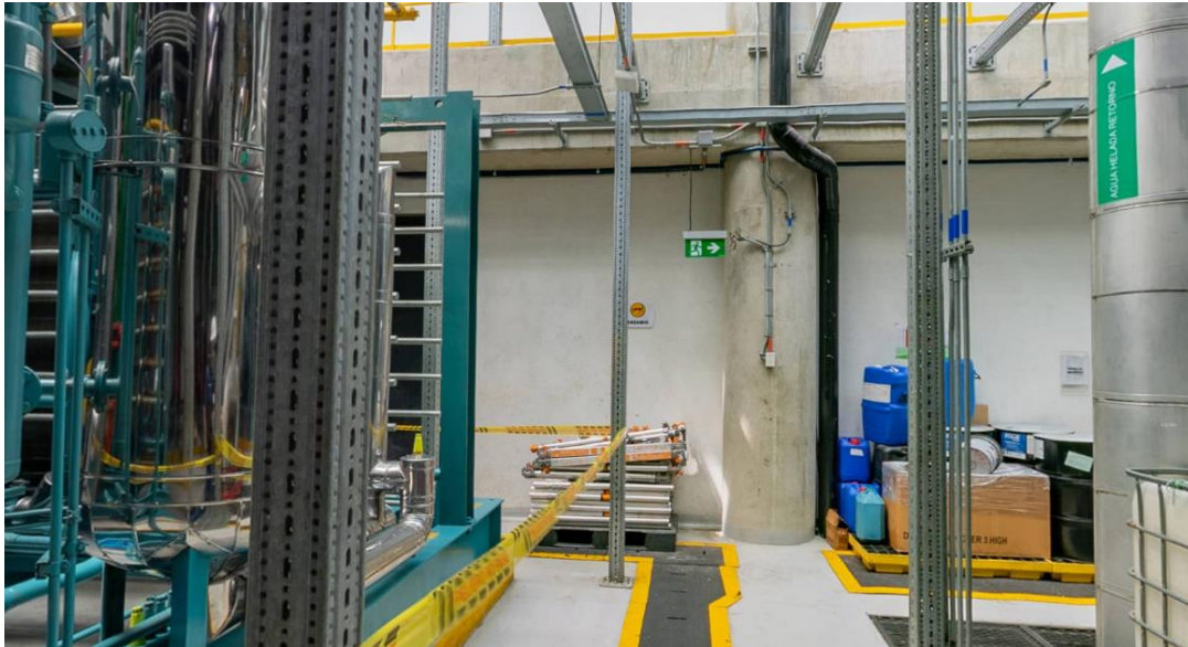
Ilustración 9 Planta de enfriamiento Distrito Térmico de Alpujarra, Medellín-Colombia
