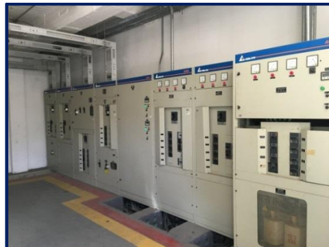
Fotografía 62 Áreas Comunes: Subestación Eléctrica
