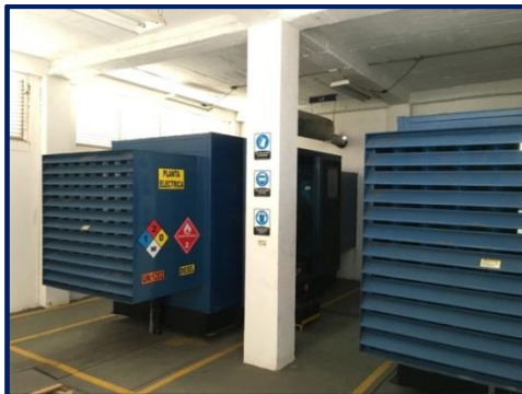
Fotografía 61. Áreas Comunes: Subestación Eléctrica
