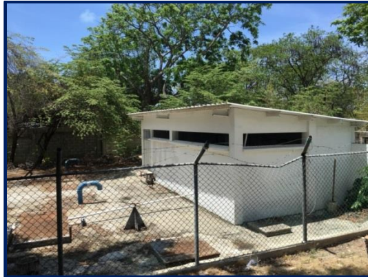
Fotografía.60 Áreas comunes: Cuarto de Bombas y Cisterna de Agua Potable
