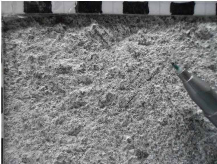
Fotografía 4.1 Fisuras presentadas CC-CC-DS-1
