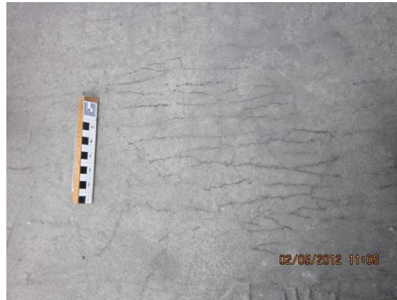
Fotografía 1.1 Agrietamiento por retracción plástica aumentada por la acción del viento
