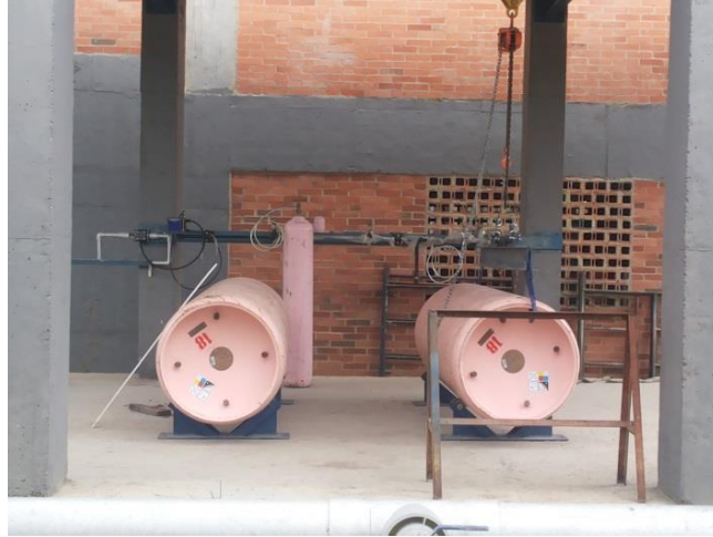
Figura 10. Clorador de la Planta Agua Potable de Tocancipá.
