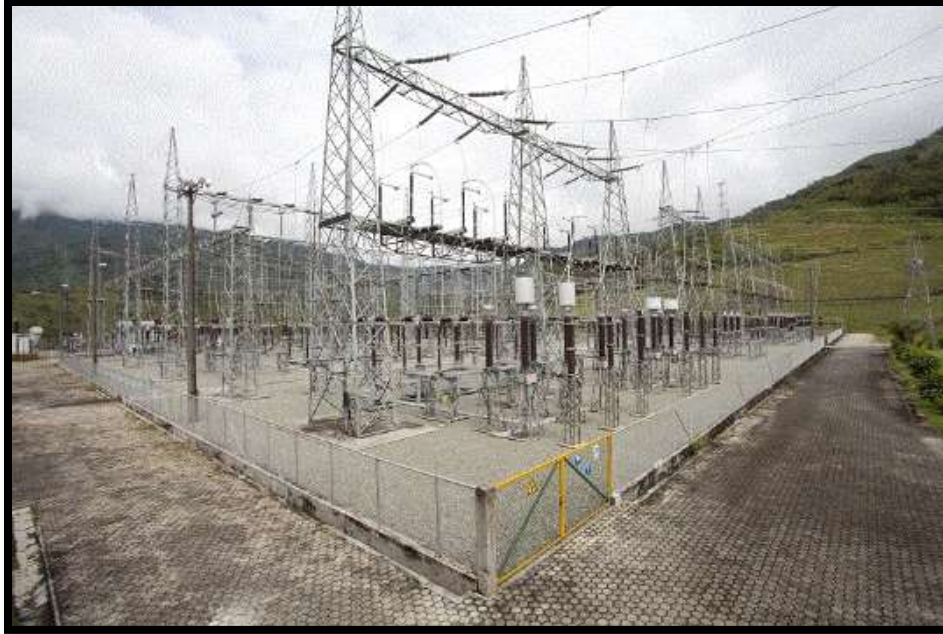
Foto 18 - CENTRAL HIDROELECTRICA LAS PLAYAS
