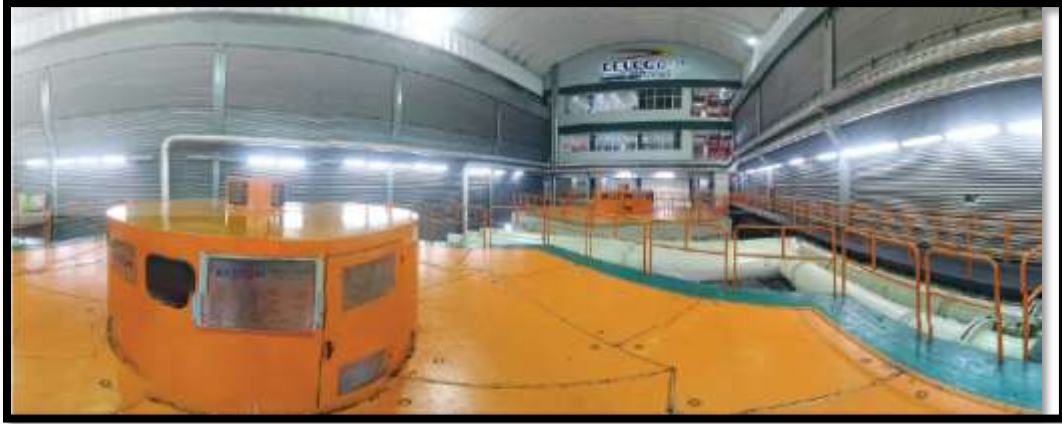
Foto 21 - INTERIOR DE HIDROELECTRICA SAN FRANCISCO
