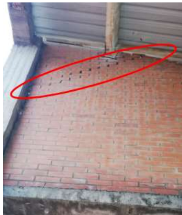
Imagen 25. Grietas en muros de mampostería.
