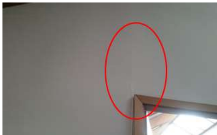
Imagen 34. Fisuras en elementos no estructurales.
