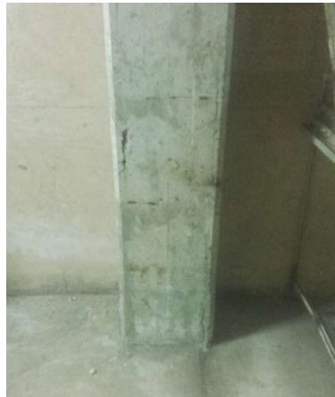
Imagen 5. Perdida de recubrimiento en columnas.
