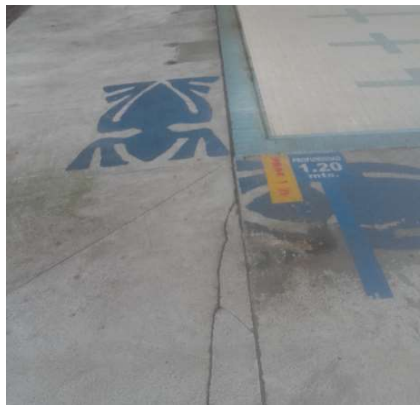
Imagen 9. Fisuras en placa alrededor de la piscina
