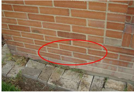
Imagen 39. Fisuras en muros de mampostería.
