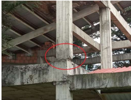
Imagen 27. Discontinuidad en las columnas.
