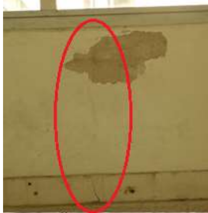
Imagen 46. Fisuras en vigas.
