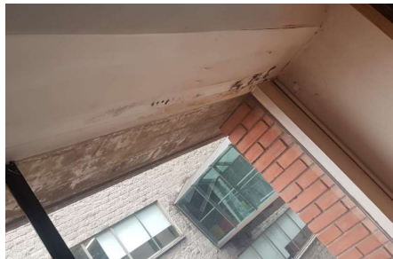
Imagen 29. Humedad en cielo raso.
