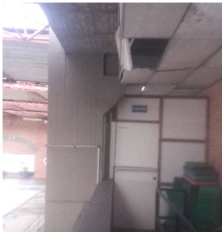
Imagen 12. Desprendimiento y humedad en cielo raso.
