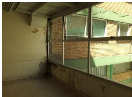
Imagen 45. Humedades y pérdida de recubrimiento.
