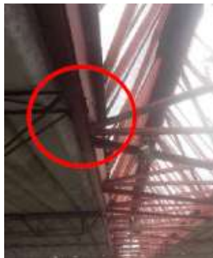
Imagen 7. Corrosión elementos de cubierta
