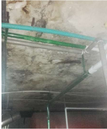
Imagen 6. Humedad en placa de entrepiso
