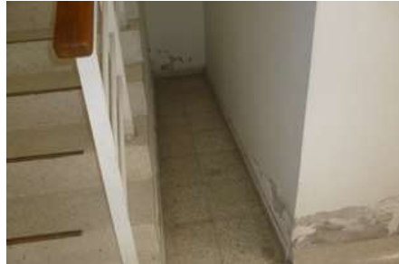
Imagen 42. Humedades en muros.
