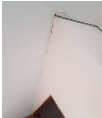
Imagen 31. Humedad en cielo raso.
