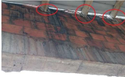
Imagen 19. Filtración de agua/anclaje inadecuado de correas.
