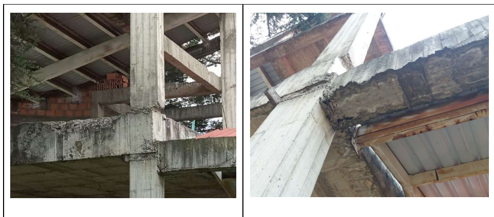
Imagen 18. Hormigueros en elementos estructurales
