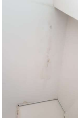
Imagen 30. Humedad en paredes.
