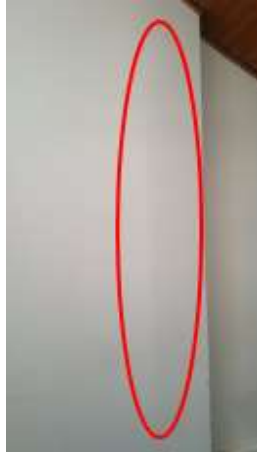
Imagen 35. Ausencia de dilatación de muros no estructurales
