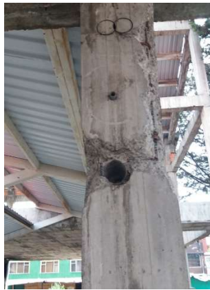
Imagen 22. Inadecuadas prácticas constructivas
