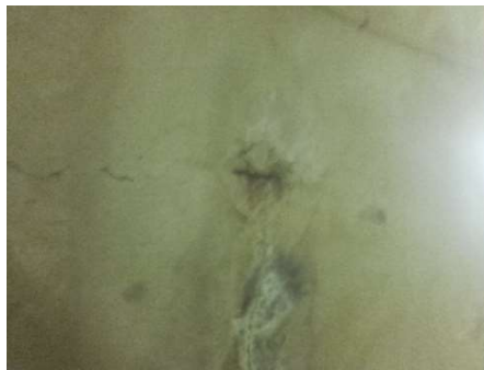
Imagen 3. Acero de refuerzo expuesto.
