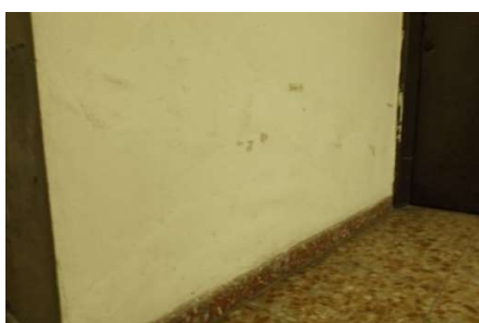
Imagen 50. Humedades en muros.
