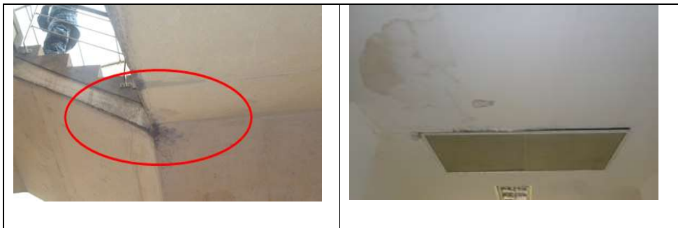
Imagen 40. Perdida de recubrimiento en columnas.
