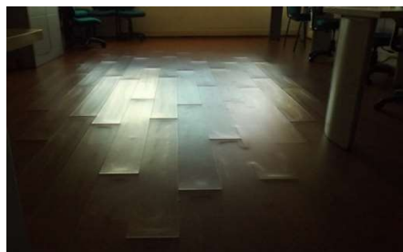
Imagen 47. Levantamiento del piso de madera.
