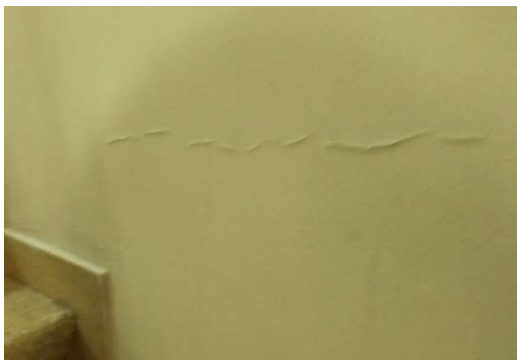
Imagen 49. Humedades en muros.
