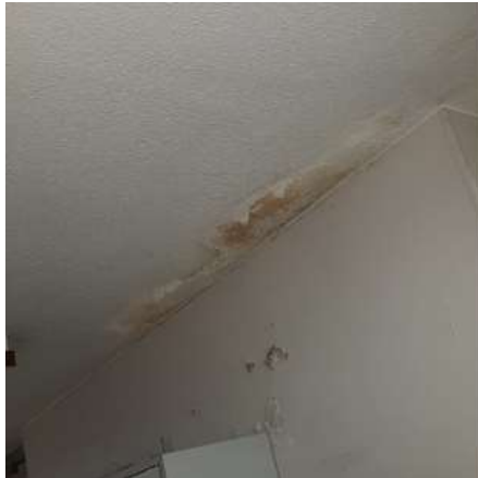
Imagen 33. Humedad en placa de entrepiso.
