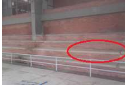
Imagen 8. Grietas en Graderías
