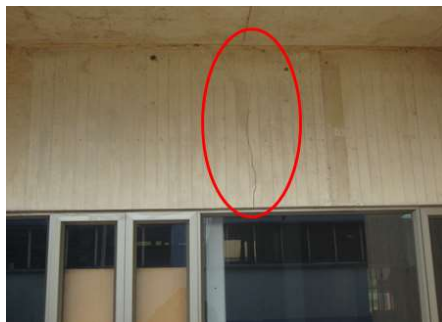
Imagen 38. Fisuras en muros de fachada.
