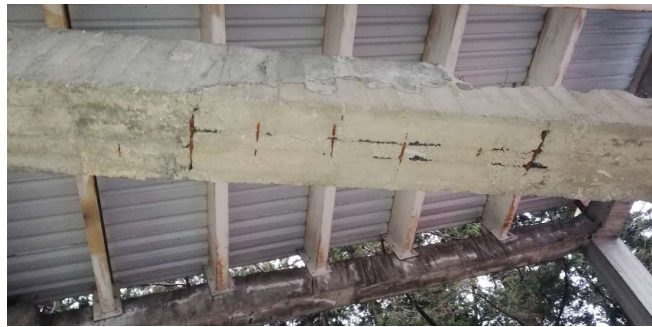
Imagen 15. Acero de refuerzo expuesto.
