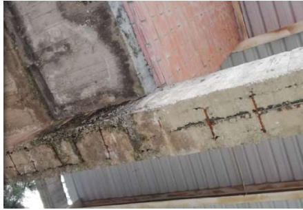
Imagen 26. Humedad y deterioro del concreto.
