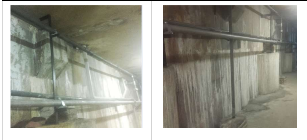
Imagen 4. Fisuras, humedad y eflorescencia.
