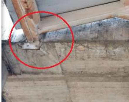
Imagen 24. Inadecuado anclaje de elementos de cubierta.
