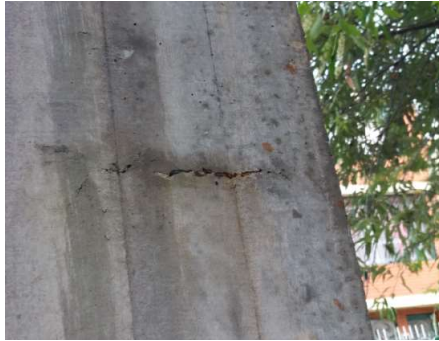
Imagen 21. Corrosión en acero de refuerzo
