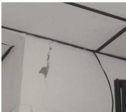
Imagen 41. Grietas en muros
