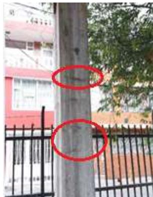
Imagen 20. Fisuras en columnas
