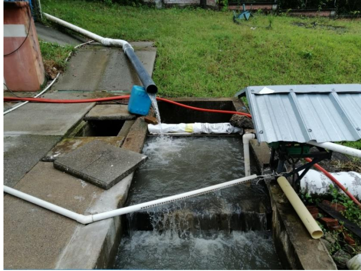
Ilustración 1 Cámara de aquietamiento
