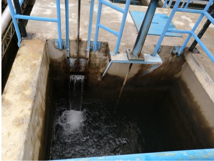
Ilustración 9 Acceso a filtros
