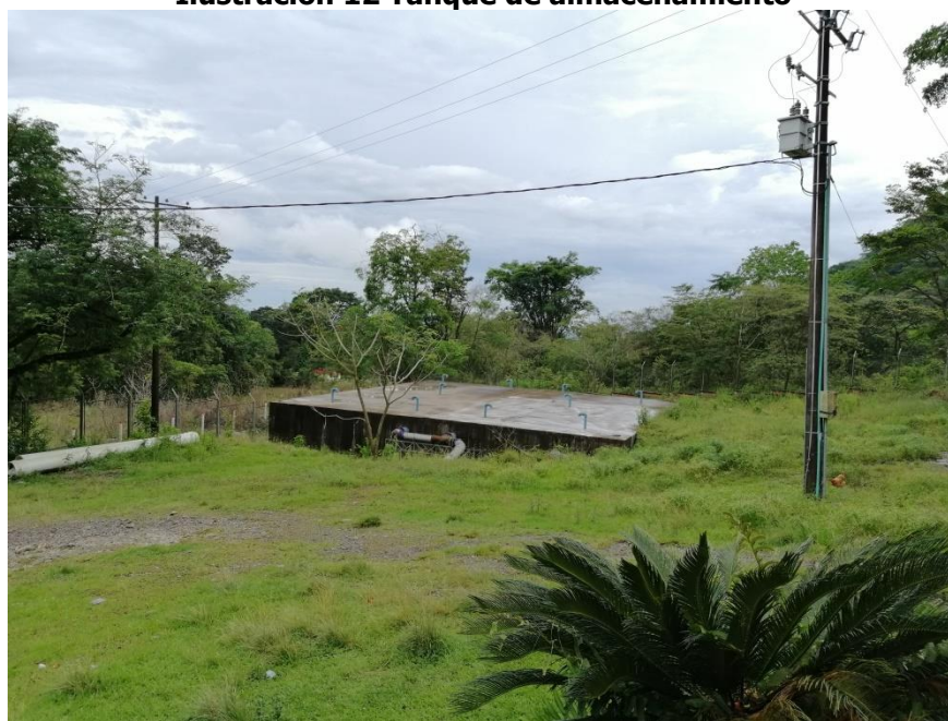
Ilustración 12 Tanque de almacenamiento
