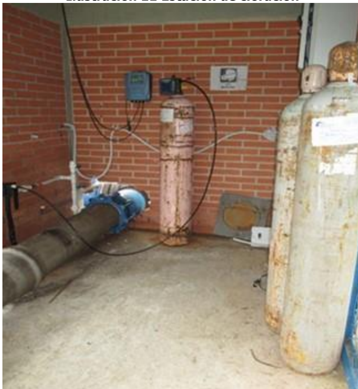
Ilustración 11 Estación de cloración
