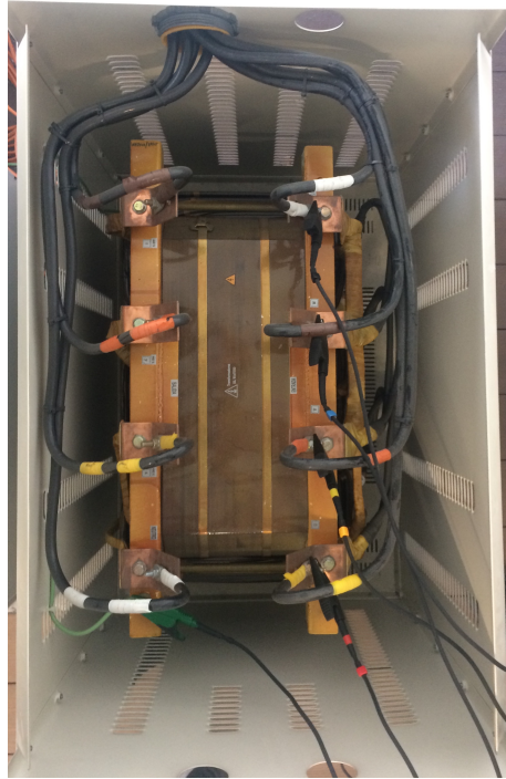
(a) Medición de tensión.
