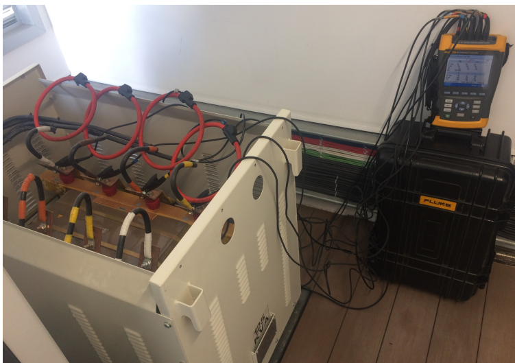
(a) Conexión del transformador al analizador
