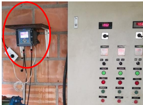
Figura 4-34 Caseta de operación de bombeo y medidor de pH
