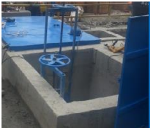
Figura 4-8 Cámara de entrada aguas residuales y distribución
