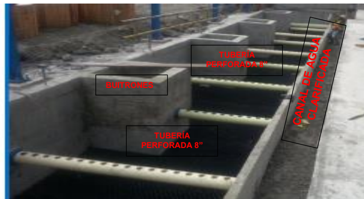
Figura 4-23 Buitrones, tubería de recolección de 8" y canaleta de agua clarificada
