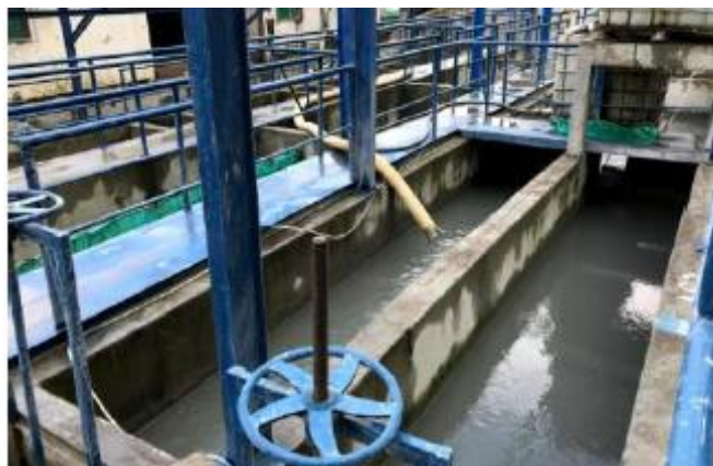
Figura 4-11 Cámaras desarenadoras antes de mezcla rápida
