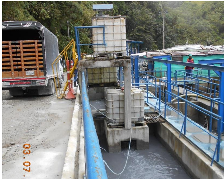
Figura 4-15 Cámara de mezcla rápida
