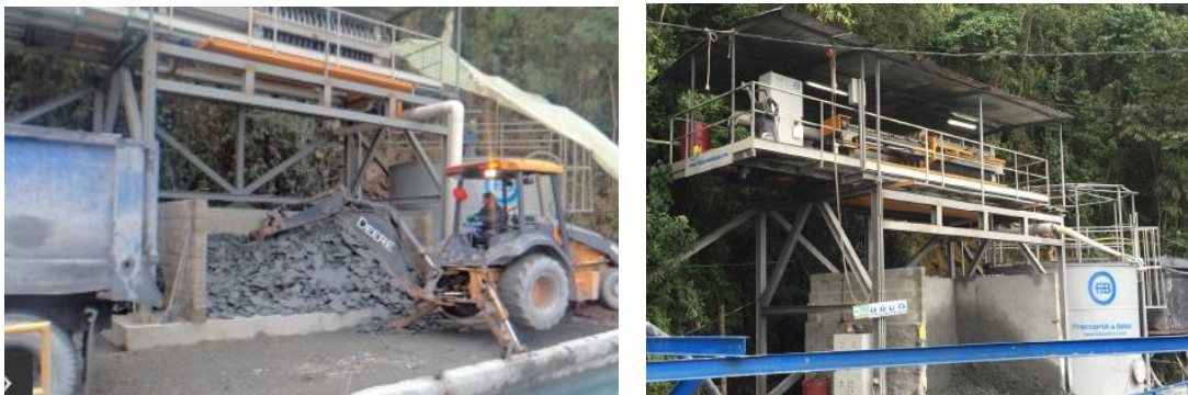
Figura 4-33 Recolección de lodos deshidratados y Área de lodos
