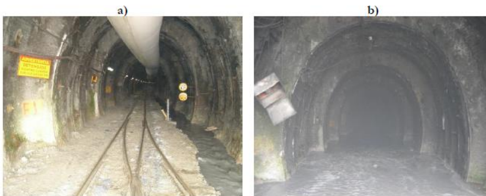
(Imagen Derecha) Agua subterránea de infiltración Q= 40 l/s (año 2007 inicio del Proyecto) y (Imagen Izquierda) Agua subterránea de infiltración Q= 140 l/s (año 2014 Año de terminación del Túnel Piloto)
