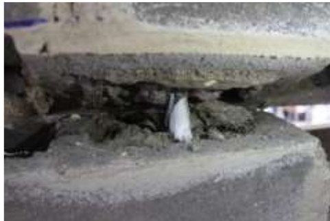
Rotura en barras FRP
