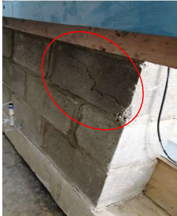
Fotografía 5-4 Falla a Compresión muro 5-1500-C-T-1,18 -B.
