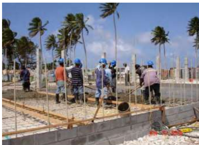
Fotografía 1-2 Uso de barras de FRP como refuerzo interno de mampostería de concreto
