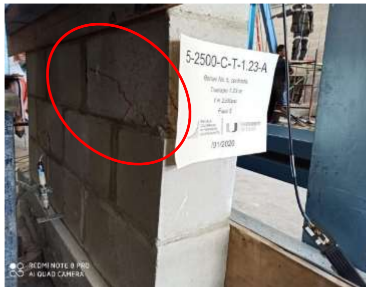
Fotografía 5-5 Falla a Compresión muro 5-2500-C-T-1,23- A.
