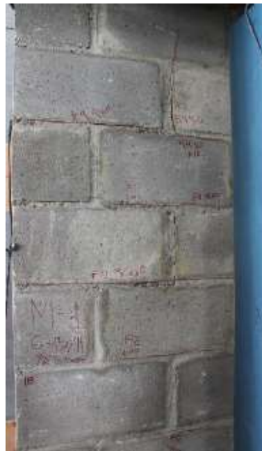
Fotografía 5-7 Falla del mortero de pega en la cara a Tensión del muro 1500-C-T-1,18- A.
