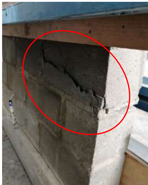
Fotografía 5-3 Falla a Compresión muro 4-1500-C-T-1,15-B.
