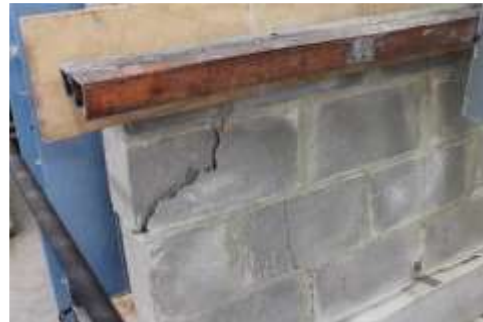
Aplastamiento en la mampostería
