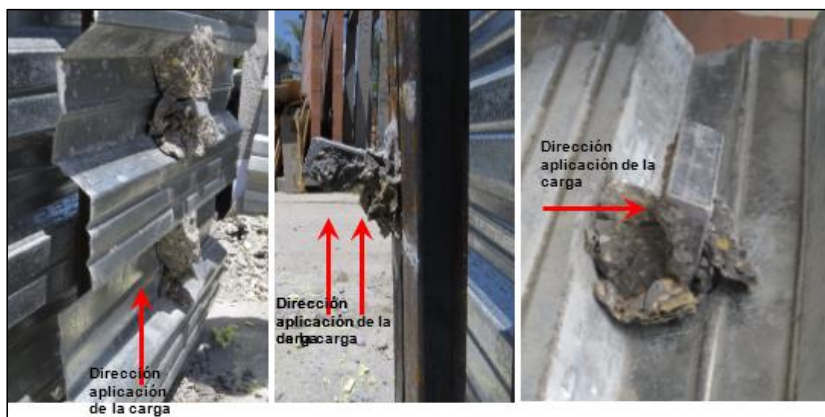
Figura 50. Aplastamiento del concreto Fuente: elaboración propia
