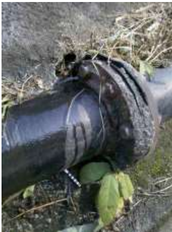
a) Categoría 1 Fuente: https://www.hidrotec.com/blog/detectar-fugas-agua-tuberias-enterradas-soluciones/
