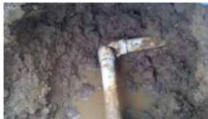
b) Categoría 2 Fuente: http://deteccionfugasagua.com/2016/12/12/fuga-de-agua-en-terrazas/
