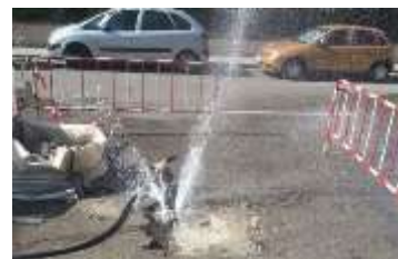
c) Categoría 3 Fuente: https://dasmecontrol.com/fugas-de-agua/
