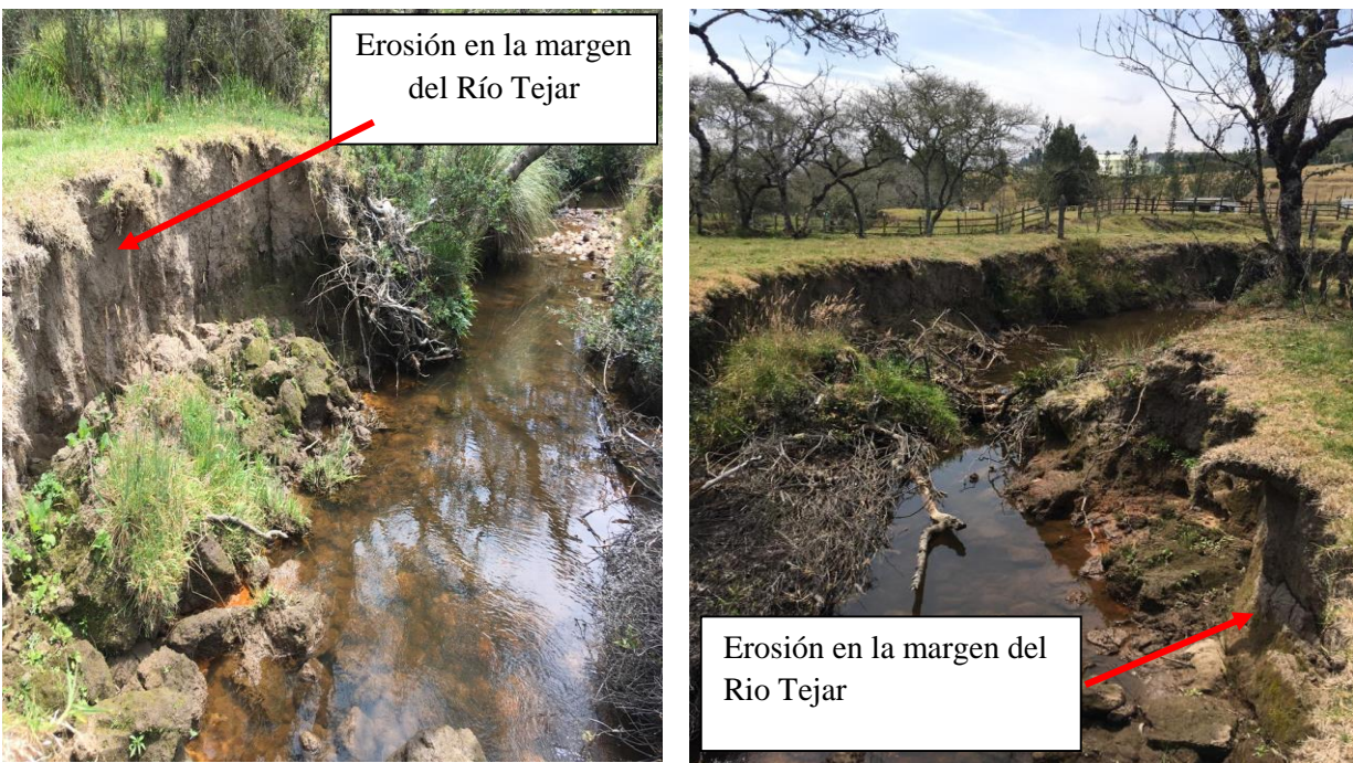
Fotografía 1. Erosión lateral de la margen del Río Tejar
