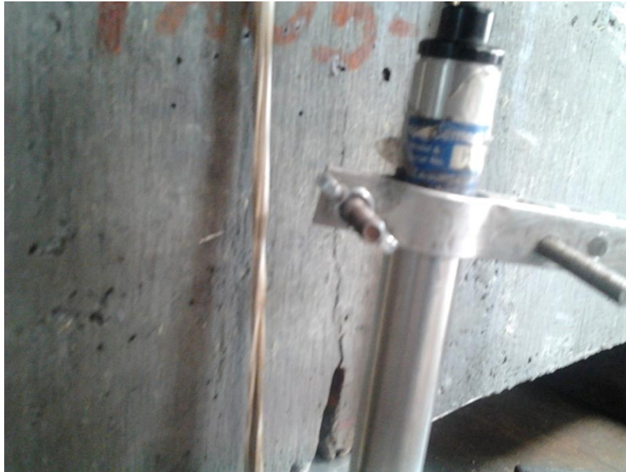
Fotografía 17. Inicio de fisuración
