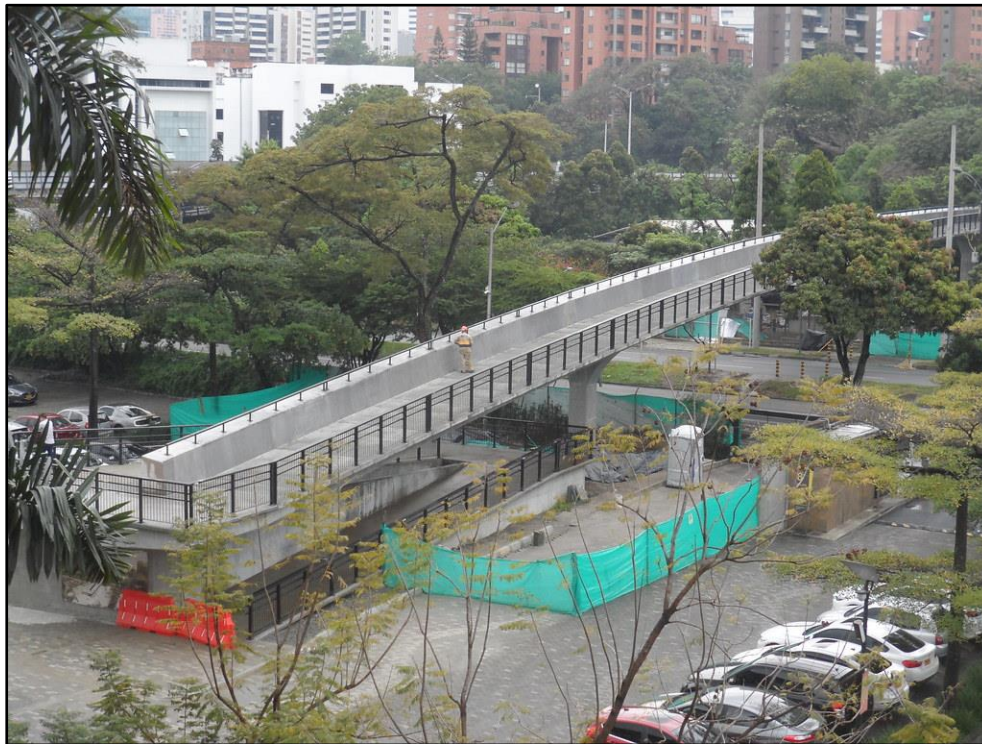
Figura 2-2. Vista del puente peatonal sobre la avenida Las Vegas en Medellín en una fase muy avanzada de su construcción en 2017 (Abellán-García, Nuñez-Lopez, et al., 2020).
