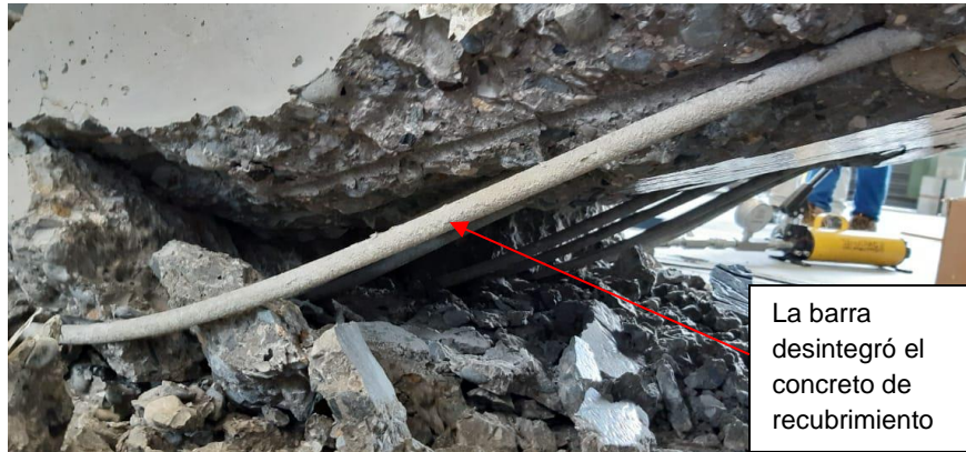
Fotografía No. 18 Barras de GFRP separadas del concreto.
