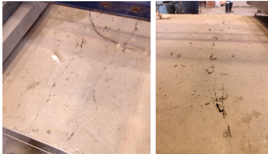
Fotografía No. 10 Fisuras en zona de compresión LCGFRP-103
