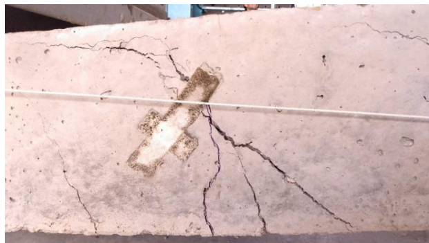
Fotografía No. 8 Fisura diagonal en el primer tercio de los elementos
