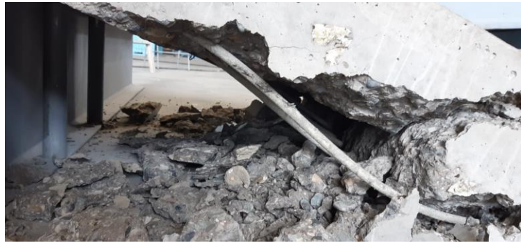
Fotografía No. 12 deformación exagerada de las de barras de GFRP LCGFRP-104
