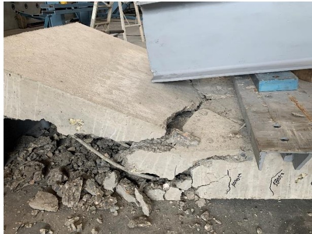
Fotografía No. 17 Elemento fracturado en zona de máximos esfuerzos cortantes.
