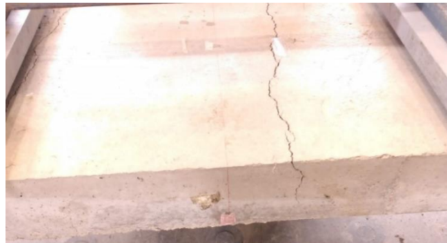
Fotografía E – 5 Fisura total en sección transversal de concreto
