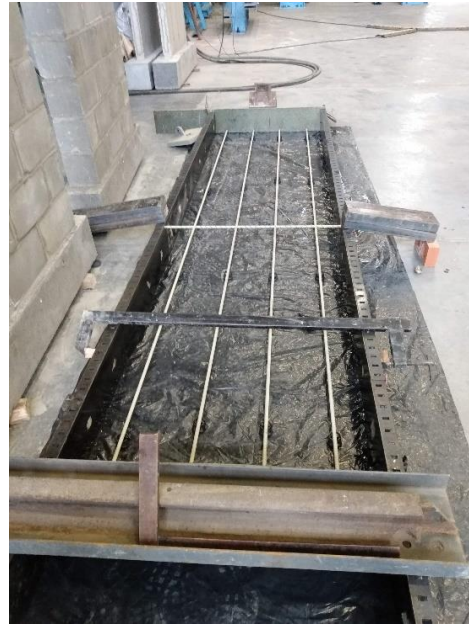
Fotografía No. 2 Localización de refuerzo
