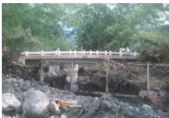
Fotografía 11 Puente Ferrocarril municipio de Útica después de avalancha noviembre 1988. Tomado (Pedraza, 2016).
