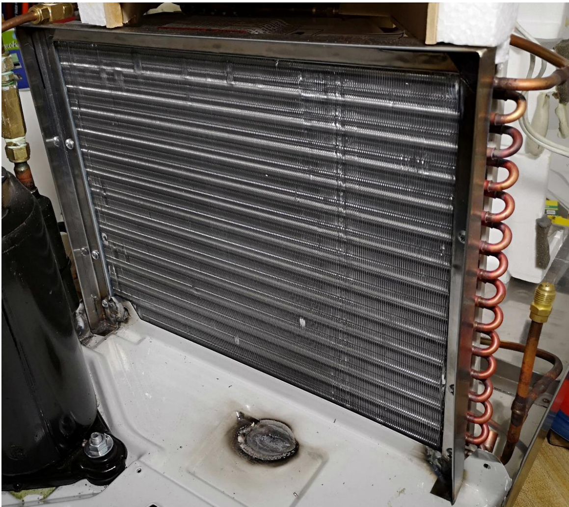
Ilustración 29. Serpentin del Condensador
