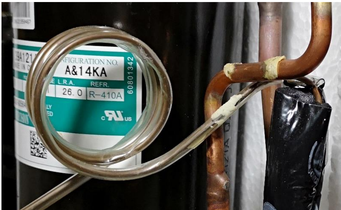
Ilustración 61. Dispositivo de control de la unidad evaporadora – Tubo capilar
