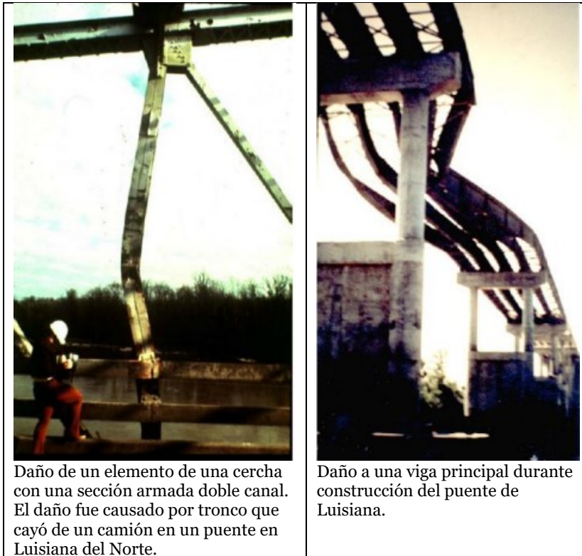
Figura 3-25. Daños sobre el eje débil.
