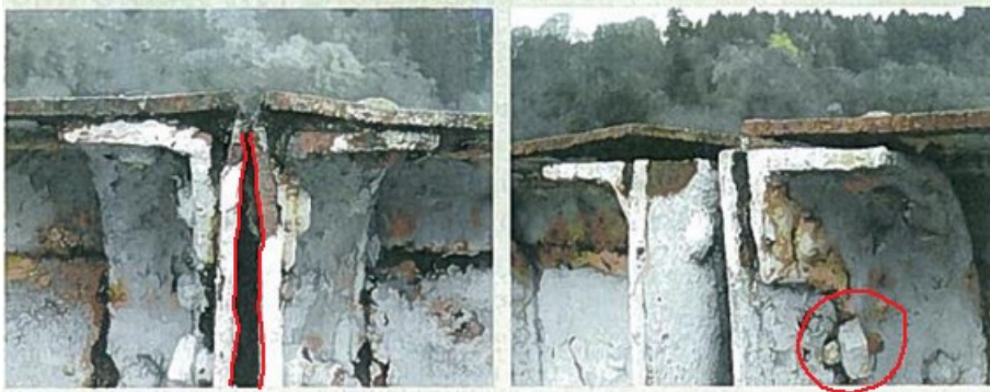
Figura 3-20. Unión Remachada Deteriorada.
