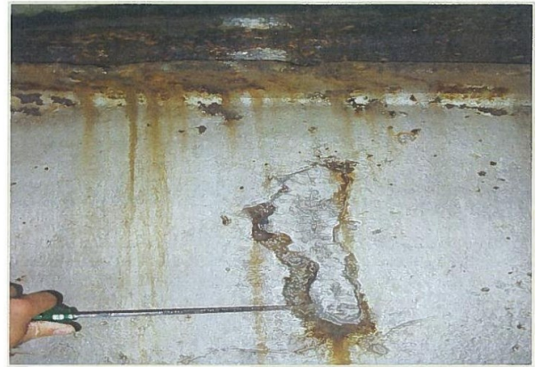
Figura 15. Defecto descubierto 100 años después. [9]
