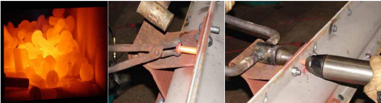
Figura 3-21. Calentamiento de remaches, introducción en los orificios y conformado de segunda cabeza.
