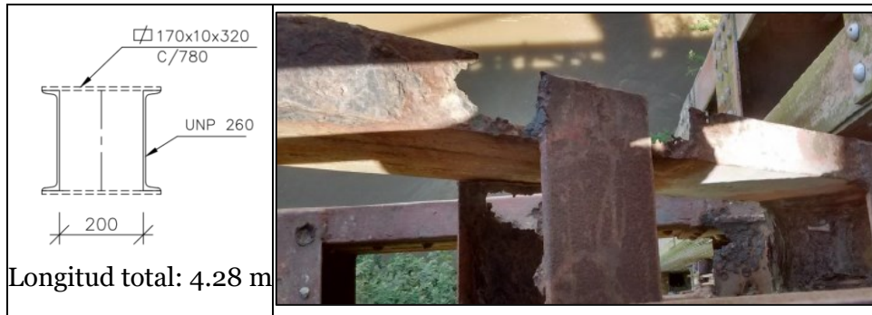
Figura 4-82. Sección transversal diagonal corroída.
