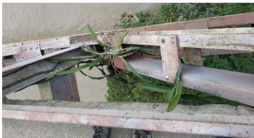
Figura 4-76. Vegetación acumulada en la cercha.
