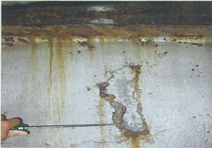
Figura 3-12. Defecto descubierto 100 años después.
