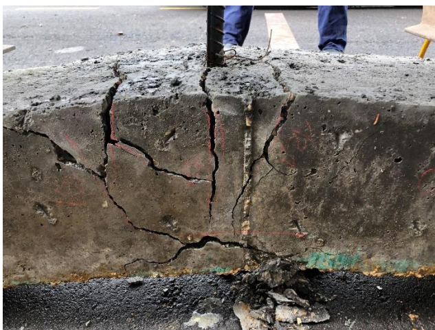
Ilustración 5 Falla flexión barra #7 (b). Fuente propia
