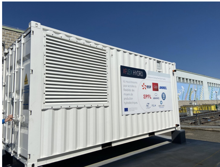
Figura 4.9: Almacenamiento de energía con baterías en la planta Vogelgrün [80].
