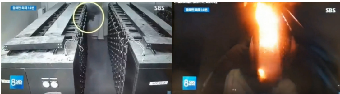
Figura 3.10: Falla en sistema de almacenamiento de energía con baterías en Asia [59].
