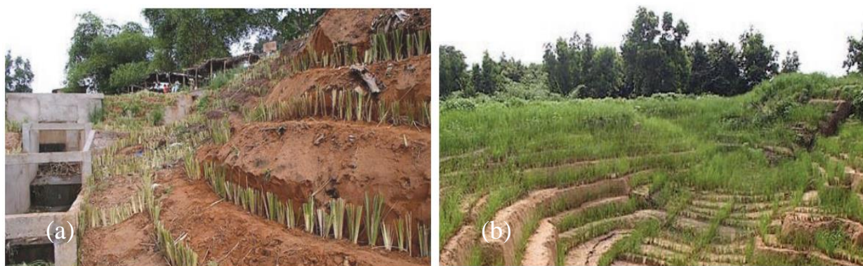
Figura N° 1. (a) Siembra de pasto Vetiver en el talud de las zonas urbanas de La República democrática del Congo. (b) se evidencia el control del drenaje y el mejoramiento del talud tres meses después de su siembra. Obtenido de (Highland & Bobrowsky, 2008).
