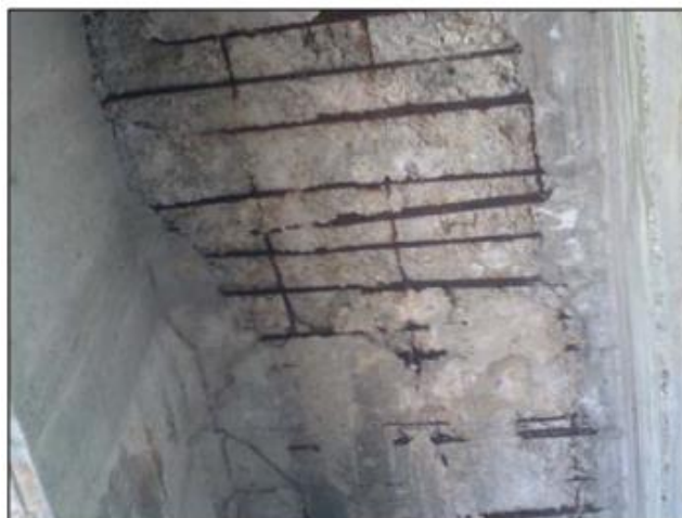
Figura 13 Patología Estructural Exposición de Refuerzo en el Puente Q. Las Ánimas. (Ministerio de Transporte Nacional de Vías., Universidad Nacional de Colombia, 2006)
