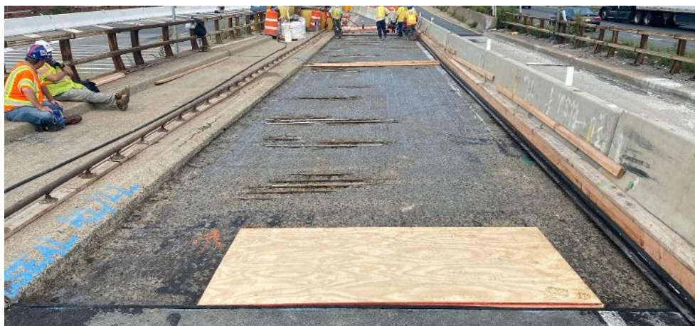
Figura 26 Exposición de acero en Brucke Expressway sobre St. Ann's Avenue. (UHPC Solutions North America, 2022)
