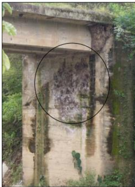
Figura 15 Eflorescencia en el Estribo del Puente del Río Meldar (Ministerio de Transporte Nacional de Vías., Universidad Nacional de Colombia, 2006)
