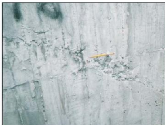
Figura 14 Junta fría con vaciado inadecuado sobre concretos existentes (Ministerio de Transporte Nacional de Vías., Universidad Nacional de Colombia, 2006)
