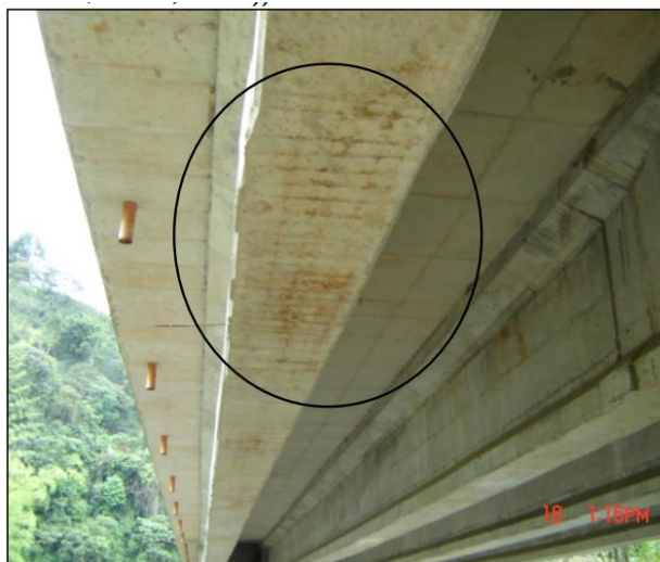
Figura 16 Manchas de óxido en superficie de concreto. (Ministerio de Transporte Nacional de Vías., Universidad Nacional de Colombia, 2006)
