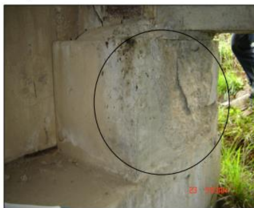
Figura 12 Patología por aplastamiento en el pedestal. Puente Cañada Profunda, Nariño. (Ministerio de Transporte Nacional de Vías., Universidad Nacional de Colombia, 2006)
