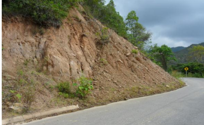
Foto 10 Talud en la carretera Neiva-Vegalarga, flujos de tierra
