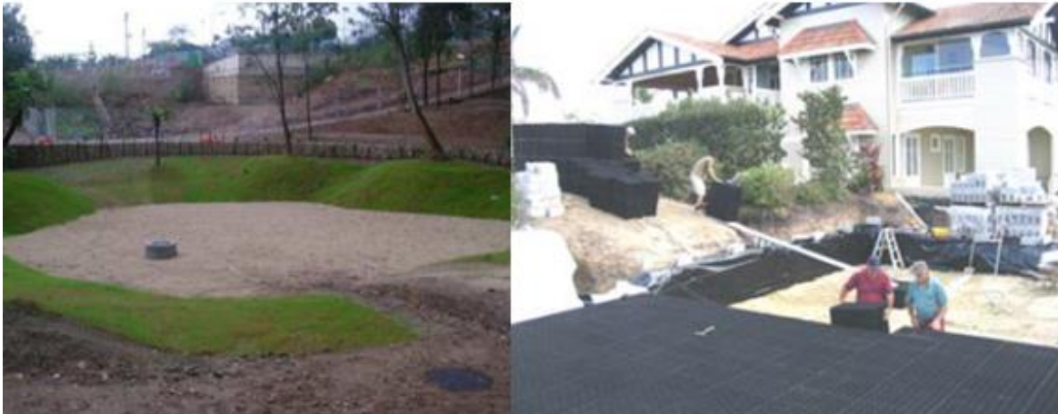
Figura 5.23 Depósito de detención (a la izquierda depósito a cielo abierto, a la derecha depósito enterrado) (36)
