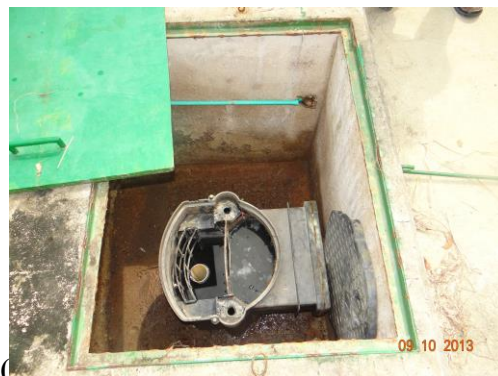
Figura 11. Decantador (ubicado al final de la PTARD)
