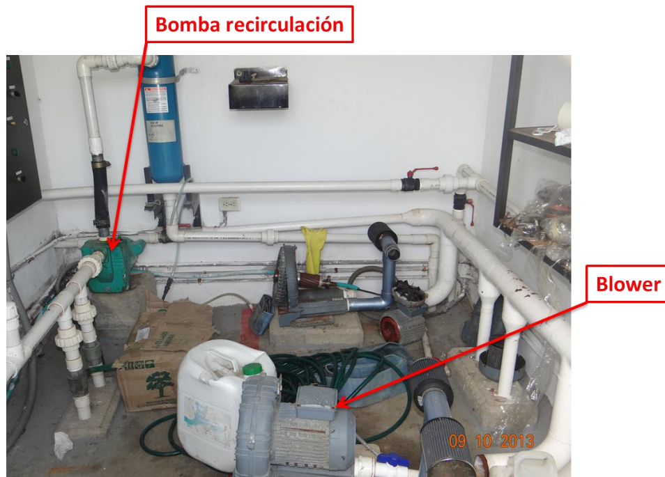
Figura 10. Bomba de recirculación y blower
