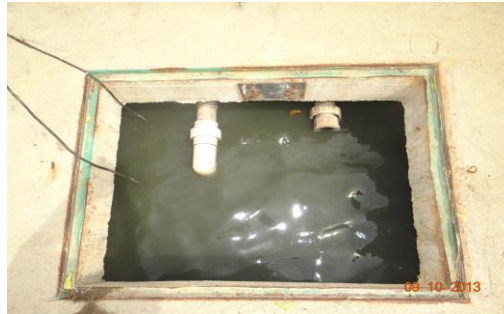
Figura 5. Equipo de bombeo (tanque equilibrio)
