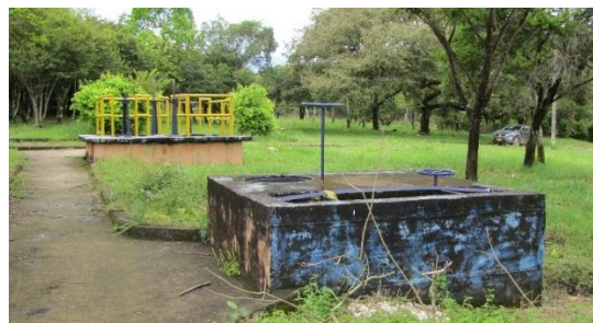
Foto 8. Cámara de Repartición
