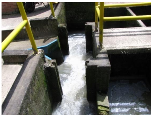
Foto 6. Entrada y salida del desarenador
