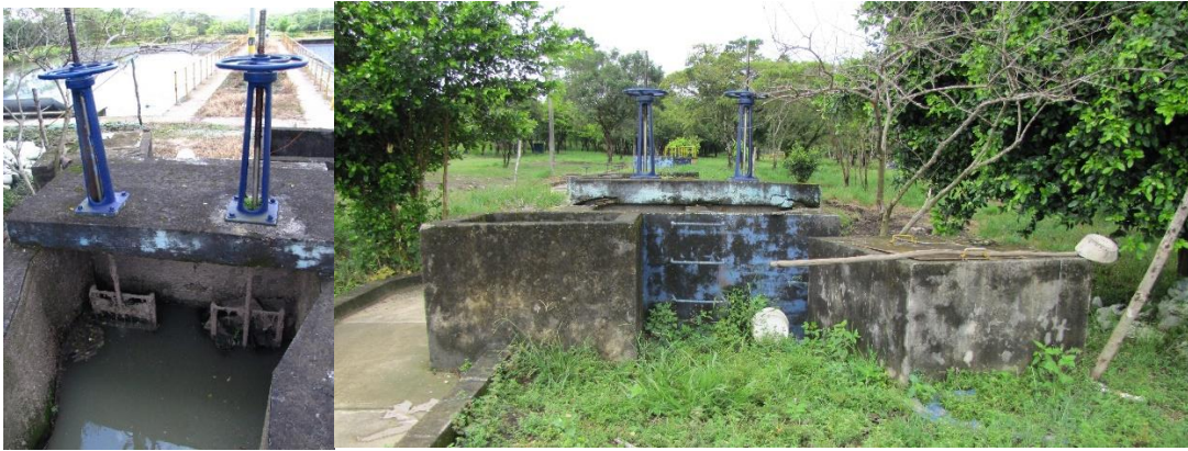
Foto 12. Válvulas de caudal de salida del desarenador No.2 y Cámaras de repartición de caudal hacia las Lagunas Anaerobias
