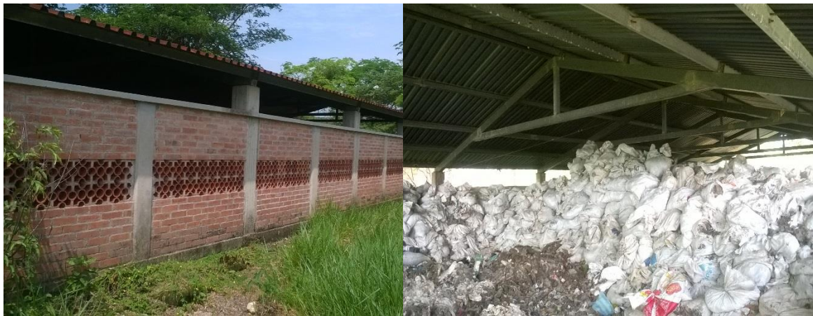
Foto 28. Lecho de secado de Lodos
