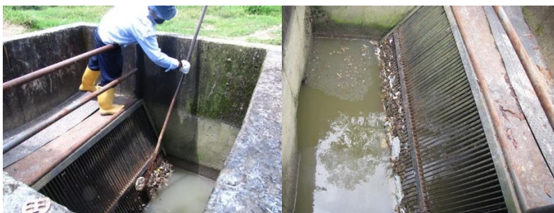
Foto 9. Cámara de cribado
