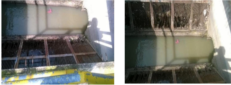
Foto 2. Rejillas Pre- Tratamiento
