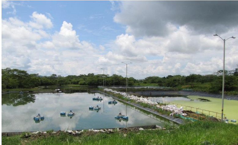
Foto 41. Lagunas Facultativas, se observa los equipos de aireación fuera de servicio en la laguna No.1, la laguna No.2 está fuera de servicio.
