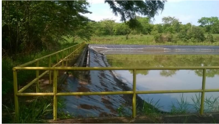
Foto 43. Obstrucción en canales y aparición de Vegetación
