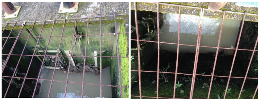
Foto 32. Compuertas cámara de entrada
