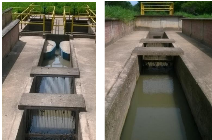
Foto 3. Segundo Sistema de Rejillas
