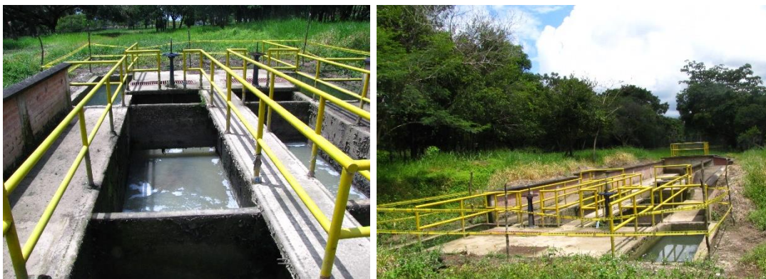
Foto 34. Desarenador con acumulación de arenas
