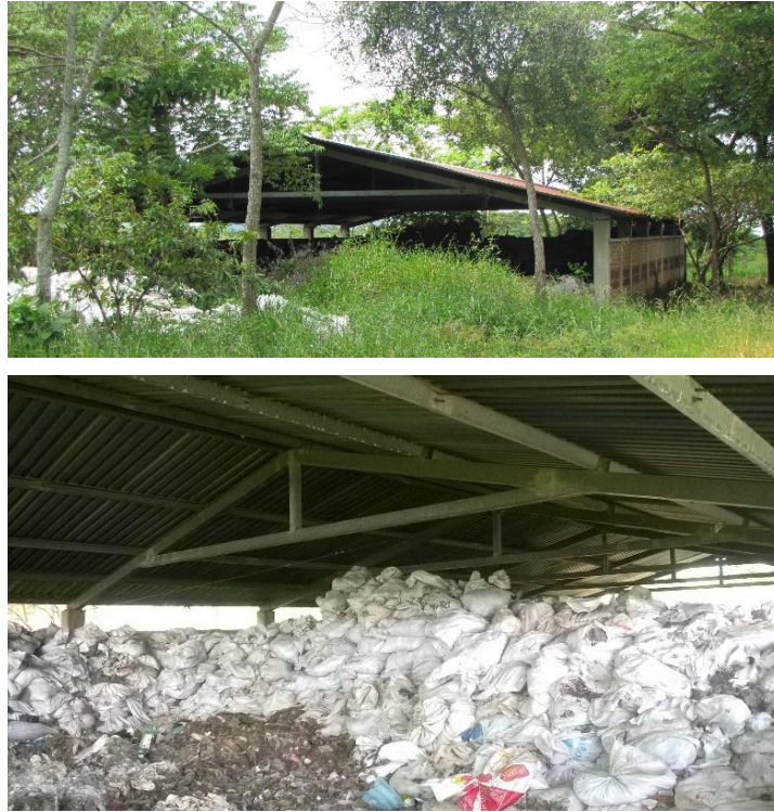
Foto 45. Estructura de Lecho de Lodos
