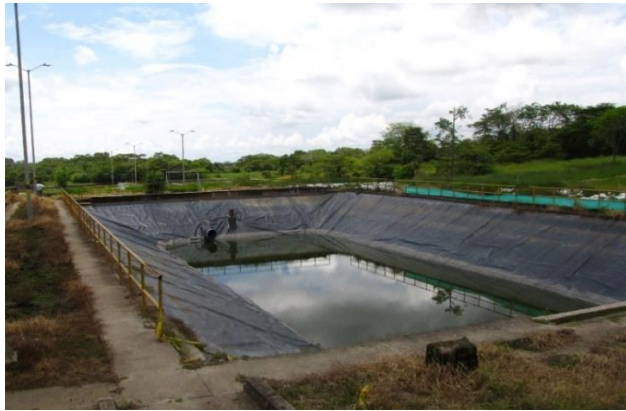
Foto 40. Laguna Anaerobia No.2. Fuera de servicio por trabajos de desenlode
