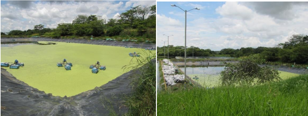
Foto 16. Lagunas Facultativas, se observa el sistema de aireación fuera de servicio.
