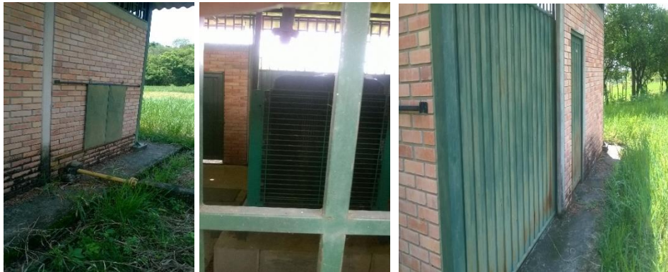
Foto 30. Planta Generadora de Energía
