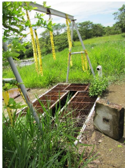
Foto 15. Estructuras de Extracción de lodos
