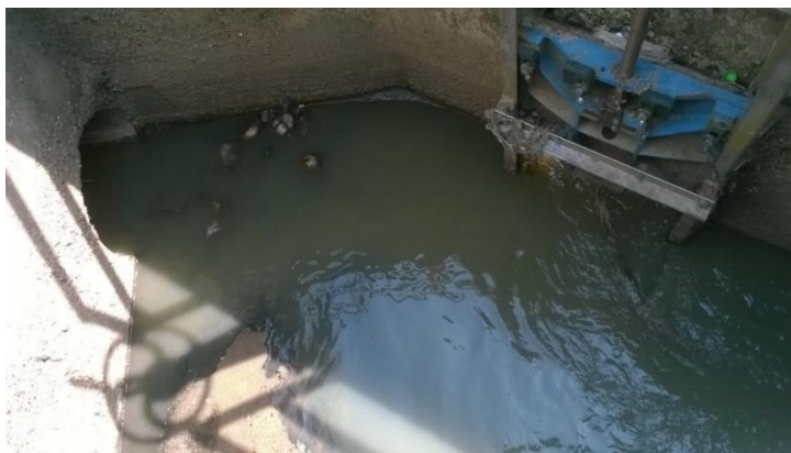
Foto 35. Acumulación de arenas en Secciones By- Pass
