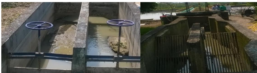
Foto 38. Sólidos en Desarenador y Rejillas
