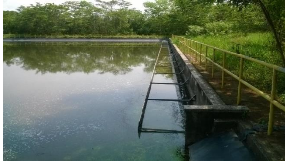
Foto 19. Vertedero y Tubería de Salida
