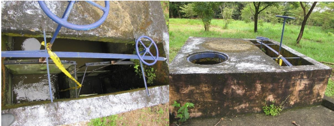
Foto 36. Válvulas de cámara de repartición
