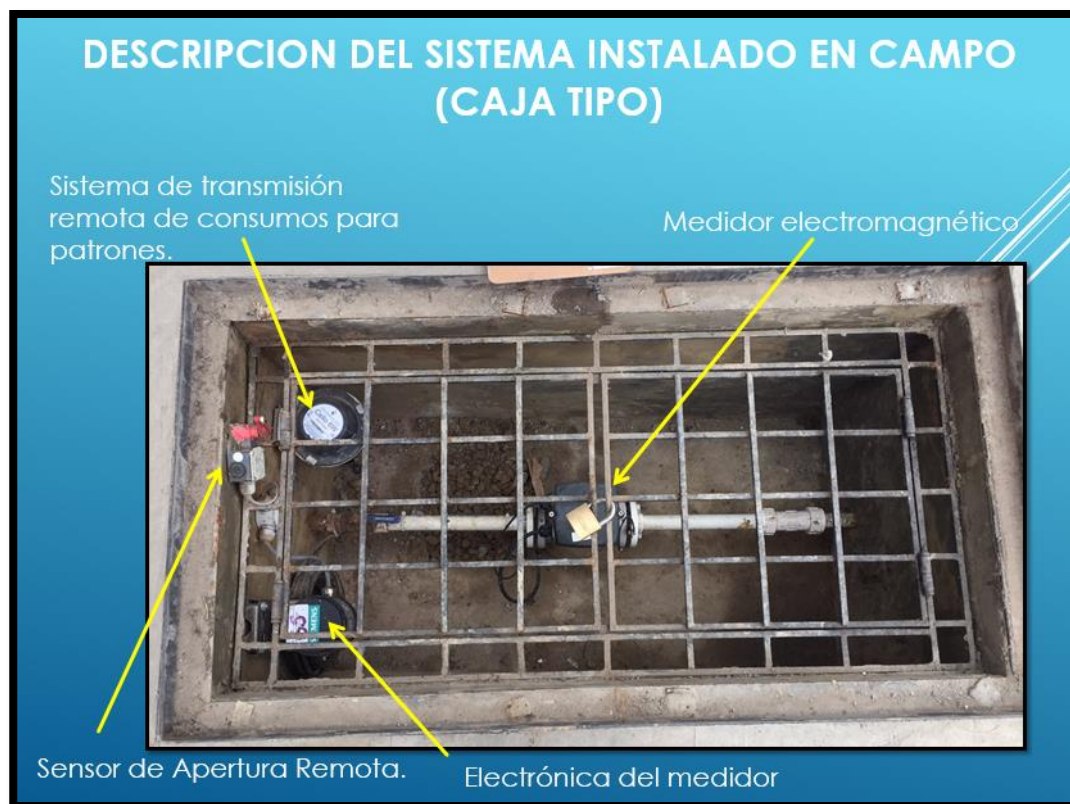
Imagen 4. Instalación Típica Medidor. Fuente Consorcio ISI 1184.
