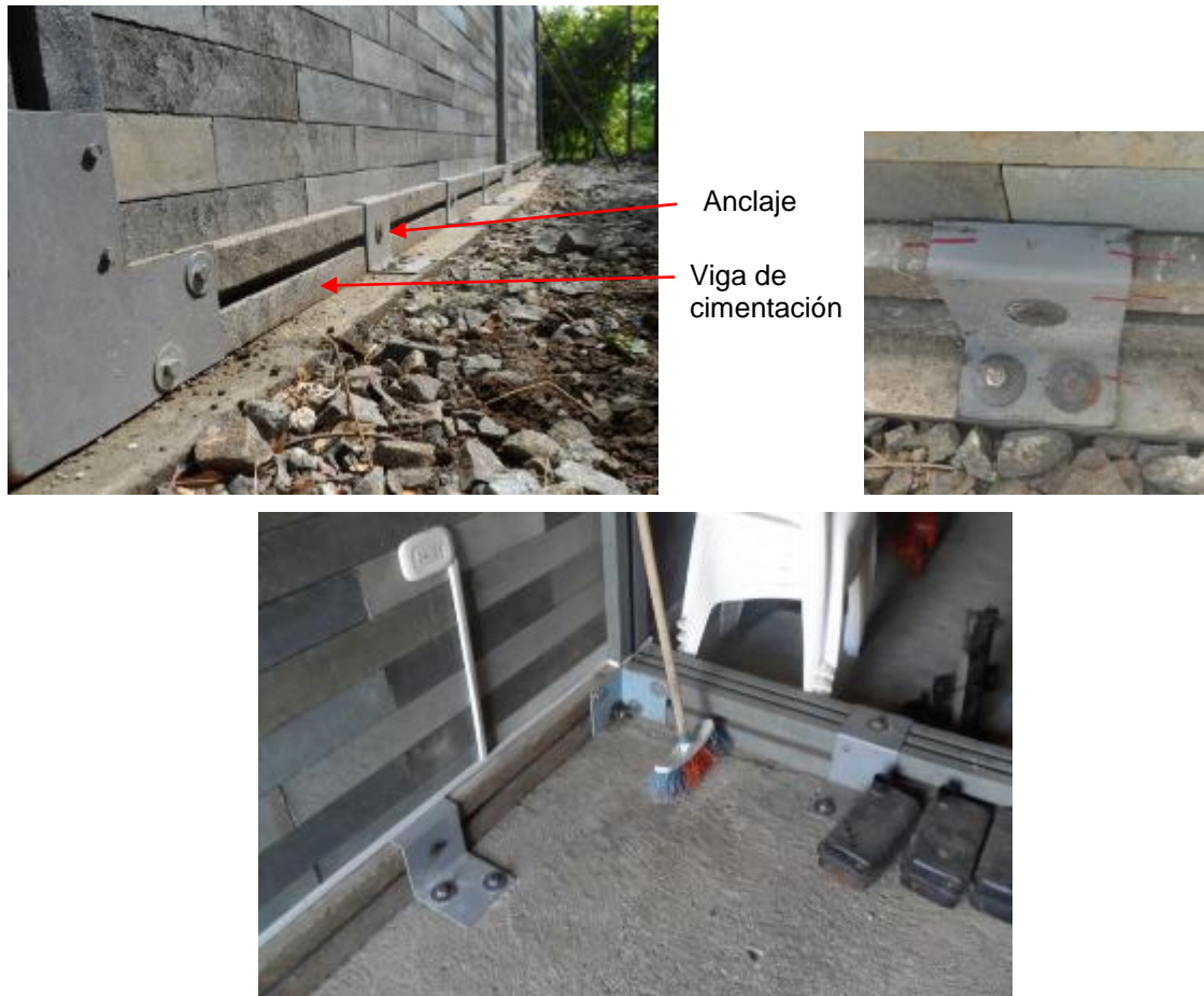
Figura 3-36: Vigas de cimentación ancladas a la losa de cimentación en estructura a escala real Fuente: Autor.
