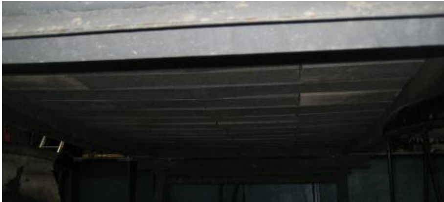
Figura 4-47: Modo de falla separación de bloques en el área interna del muro sometido a ensayo de carga uniforme perpendicular al plano del muro. Fuente: Autor.
