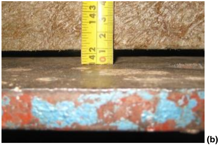
Figura 4-42: (a) (b) Detalle de comportamiento de viga inferior, muro a escala real sometido a fuerza cortante. Muestra 2. Fuente: Autor.
