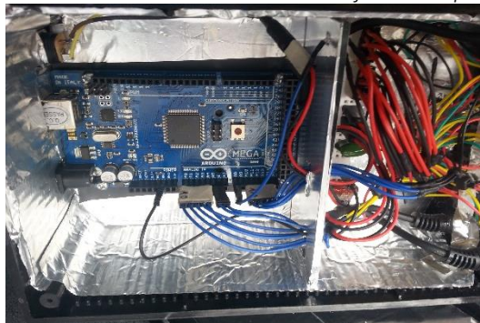
Figura 34. Apantallamiento con Aluminio en la Caja de Recepción de Señales
