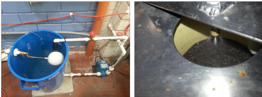
Figura 84. Tanque de Suministro y Válvula Aspersora
