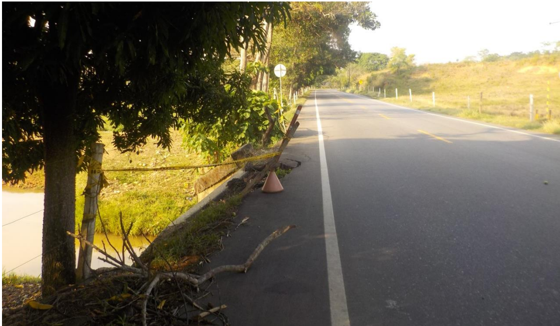
Figura 18. Alcantarilla bloqueada, estancamiento de aguas que genera problemas en los terraplenes y pérdida del hombro de la vía. Fuente: Propia.
