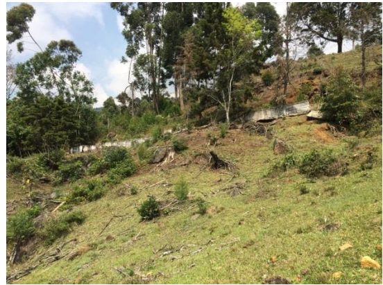
Daños en dissipadores
