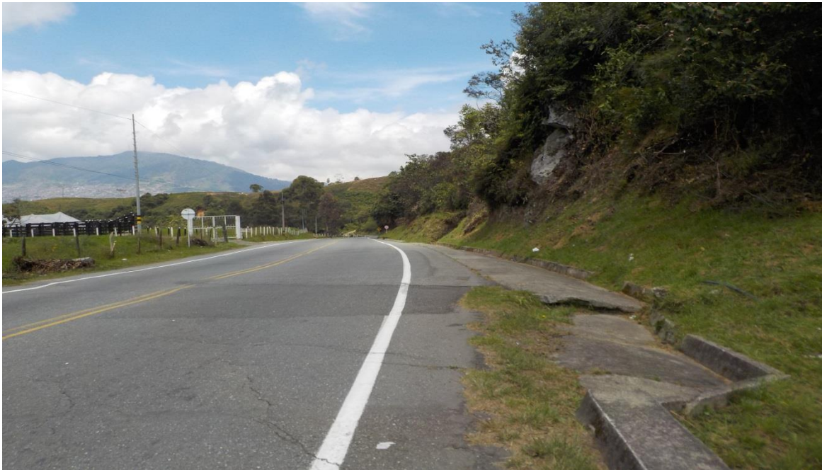
Figura 19. Cuneta averiada, grietas y fractura de cunetas causadas por el movimiento del suelo, zona de infiltración de agua hacia la estructura de la calzada. Fuente: Propia.
