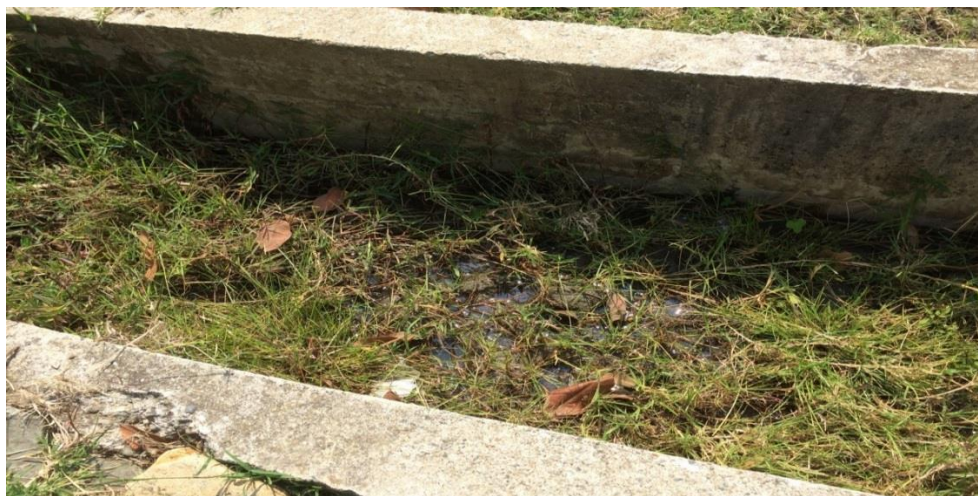
Figura 63. Presencia de agua en dissipador. Fuente: Propia.
