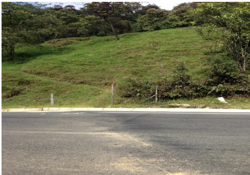
Figura 17. Abultamiento en la calzada, causado por el desplazamiento de la masa en el talud que se presenta, se observa como la línea de falla es continua. Fuente: Propia.
