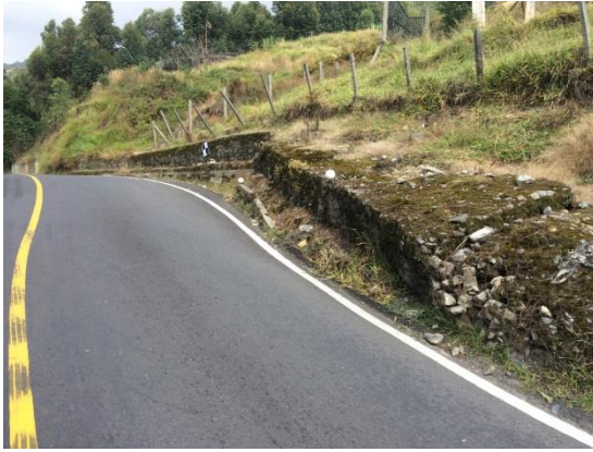
Colapso de muros de contención
