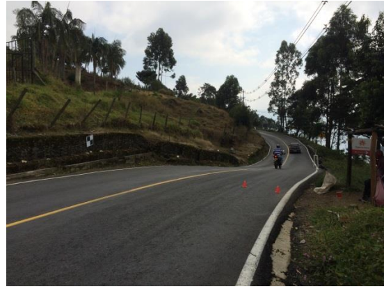
Inclinación de cercas de cerramiento
