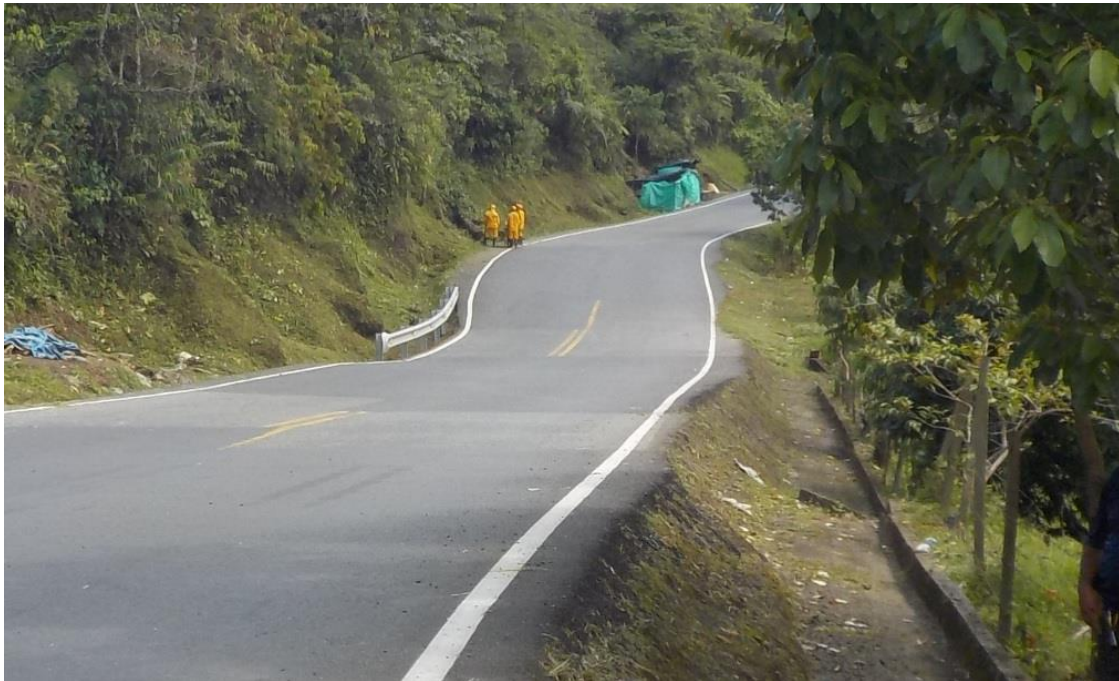
Figura 15. Hundimiento de zona, se evidencia tanto en la baranda como el terraplén.
