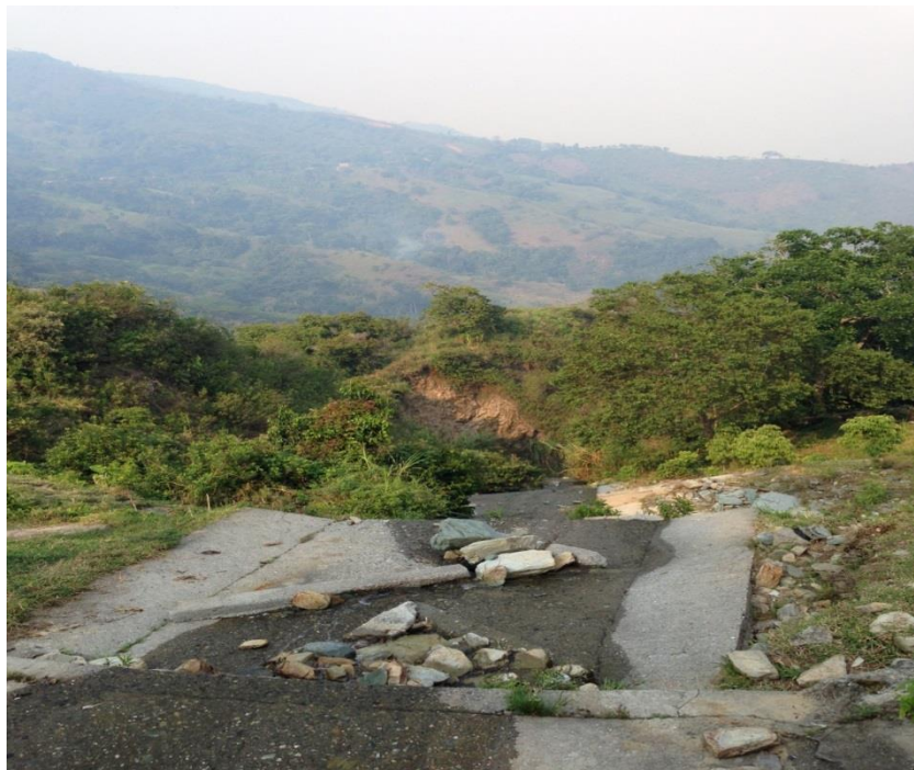
Figura 20. Mal entrega de aguas, disipador construido para evacuar las aguas de la vía, causando erosión hacia la parte baja del talud, futura inestabilidad del talud. Fuente:
