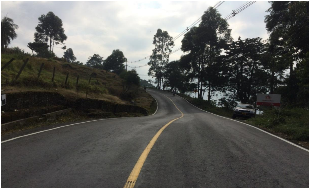
Figura 54. Hundimiento de sub rasante sitio de estudio. Fuente: Propia.
