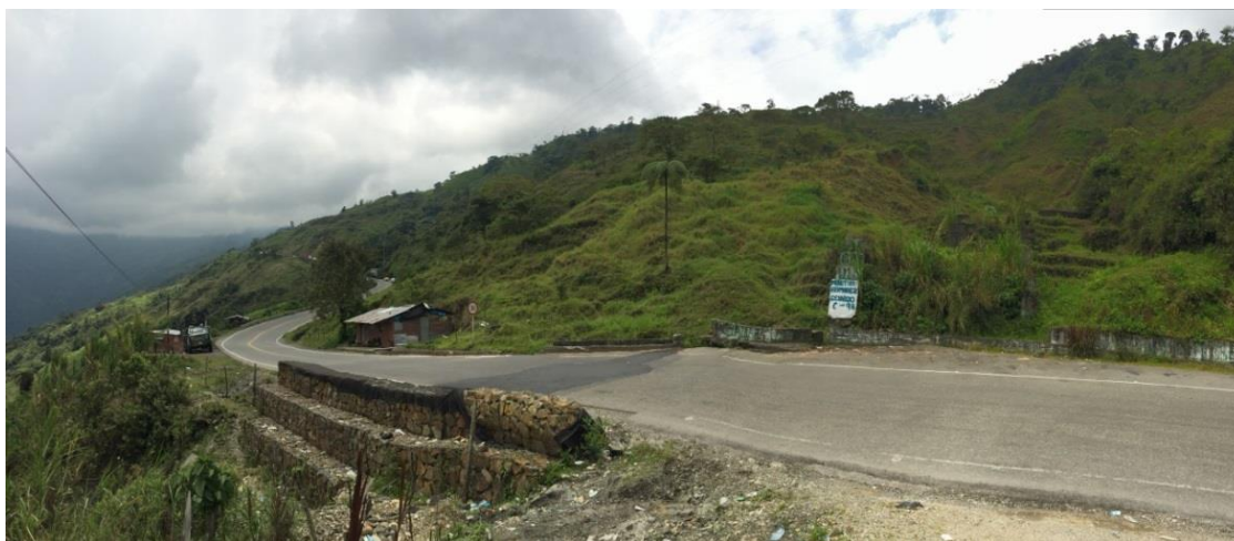
Figura 22. Estructuras afectadas por deslizamiento. Fuente: Propia.
