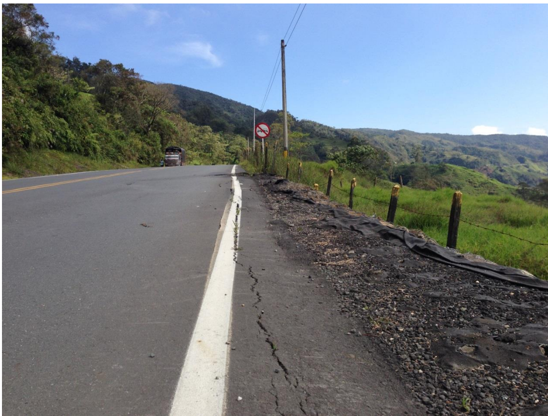
Figura 13. Grietas de tracción en pavimento, indicando el movimiento del talud que conforma la banca. Fuente: Propia
