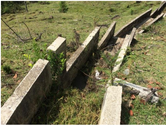
Daños en dissipadores
