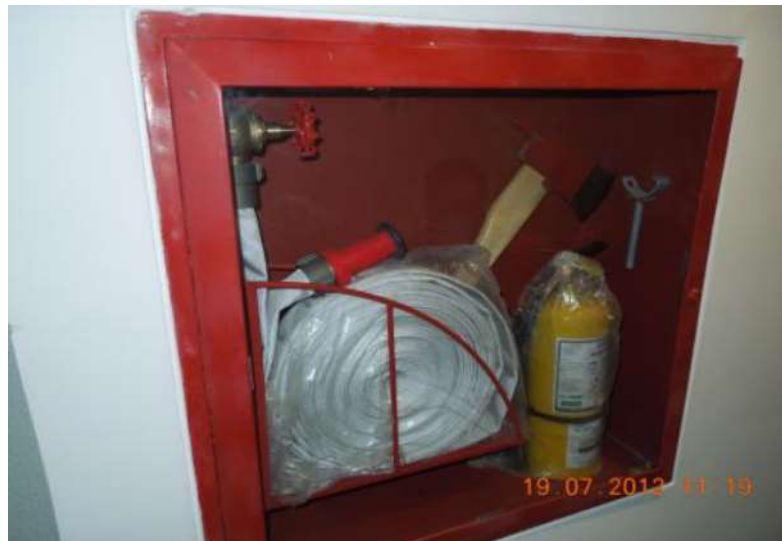
Sistema incendio clase III
