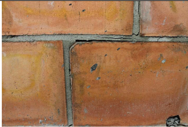
(c) Detalle de la falla escalonada
