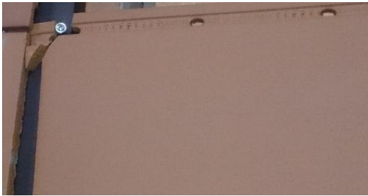
(c) Falla en la conexión de la pieza de fachada al perfil.
