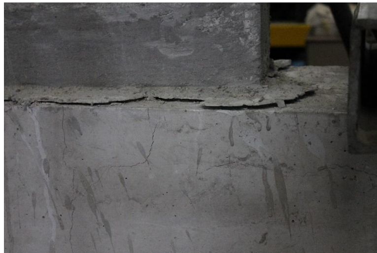
(a) Falla en la base del muro por ineficiencia en el anclaje muro-viga.
