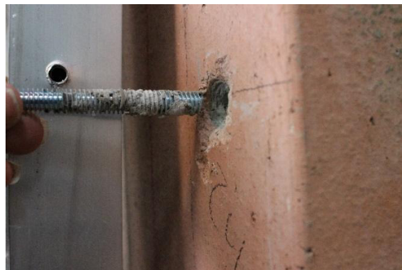
(b) Falla del anclaje químico
