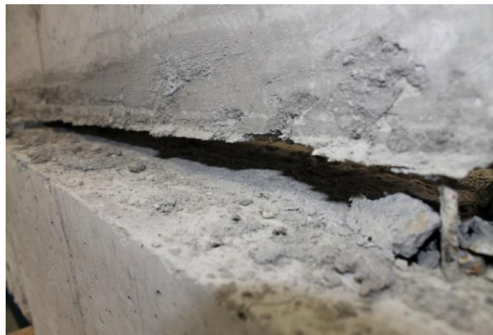
Fotografía 5-8 Detalles típico de la falla de los muros de concreto
