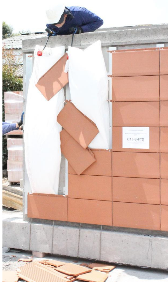
(a) Falla de la fachada con tornillo
