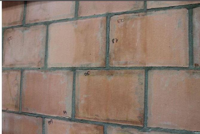
(c) Detalle de la falla escalonada
