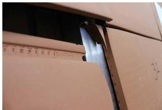
(c) Falla de la conexión de la pieza de fachada al perfil
