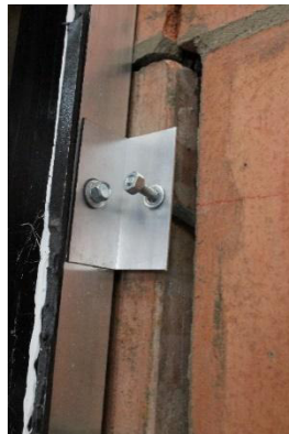
(c) Desplazamiento de uno de los perfiles de soporte
