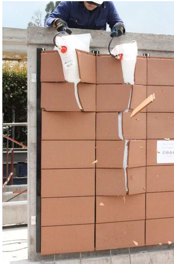
(a) Falla de la fachada adherida
