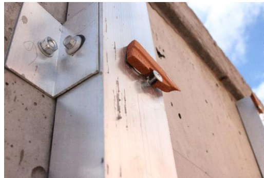
(b) Detalle de falla de la conexión de las unidades de arcilla de fachada después del ensayo
