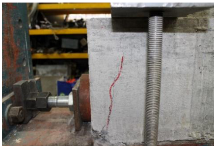
(c) Fisura en la viga de soporte
