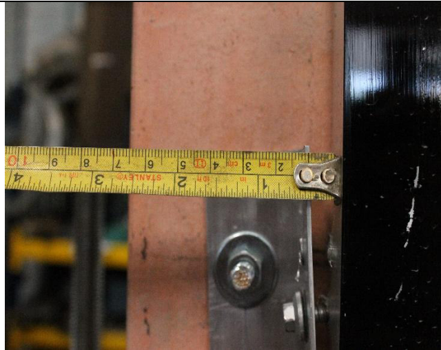
(c) Desplazamiento de uno de los perfiles de soporte
