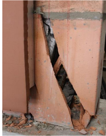
(d) Aplastamiento y rotura del ladrillo en la zona de compresión
