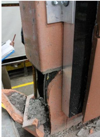
(b) Aplastamiento en base en la zona de compresión-tensión
