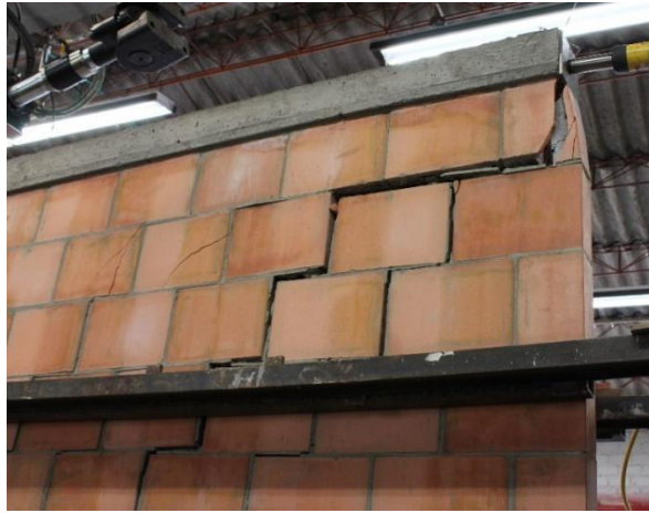
(c) Detalle de la falla escalonada
