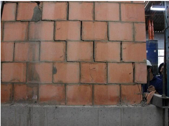
(a) Falla escalonada en muros de mampostería
