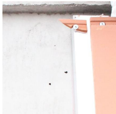
(b) Detalle de la conexión después del ensayo
