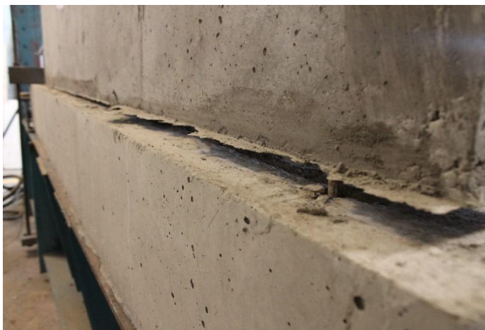
Fotografía 5-10 Detalles típico de la falla de los muros de concreto
