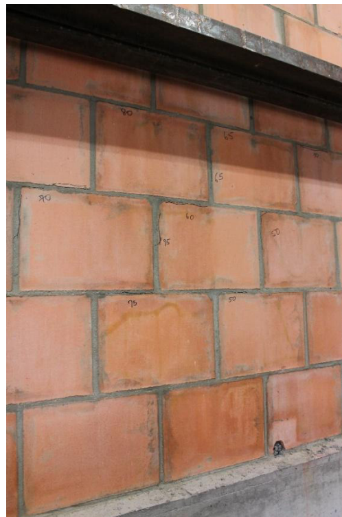
(b) Falla escalonada en la cara posterior del muro
