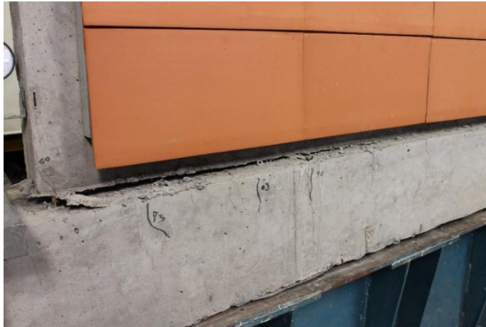
(a) Falla en la base del muro
