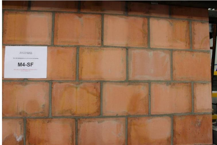
(a) Falla escalonada en la cara frontal del muro
