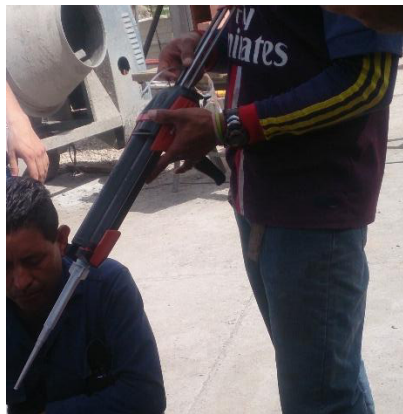
(c) Se rompe el sello del epóxico
