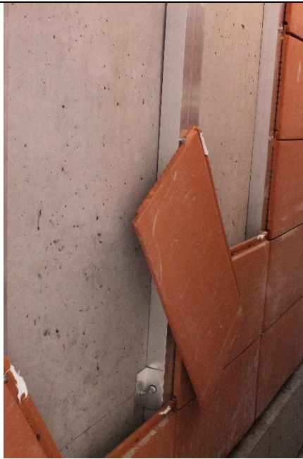
(a) Desprendimiento de las unidades de la fachada con tornillo
