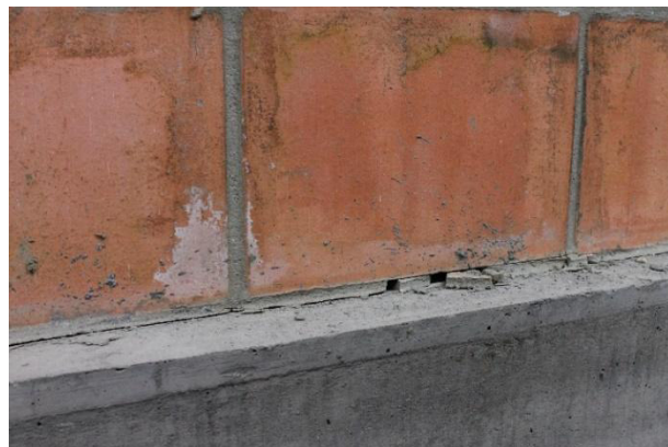
(b) Detalle de las fisuras en la base del muro
