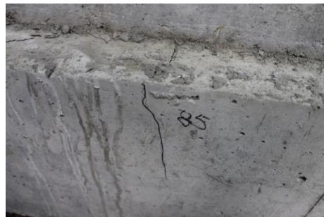
(c) Fisura en la viga de soporte.
