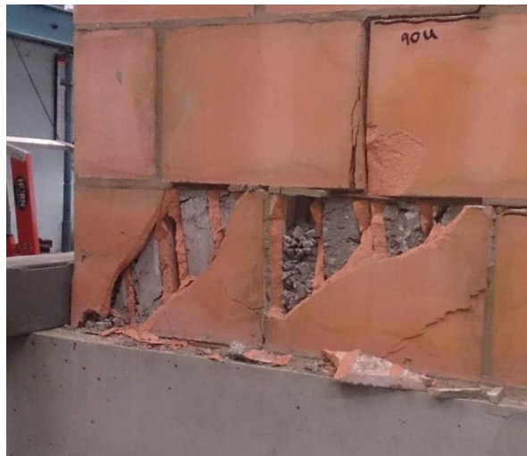
(b) Aplastamiento de los ladrillos en la zona de compresión
