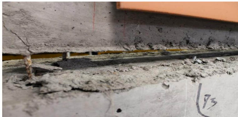
(b) Detalle desprendimiento de la base del muro
