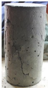
Fotografía 5-4 Falla de los cilindros de grouting durante el ensayo de compresión
