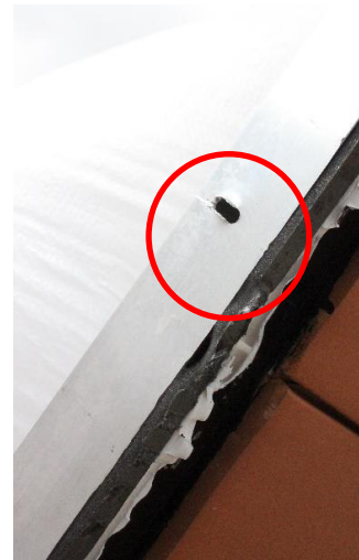
(d) Detalle del desgarramiento del perfil
