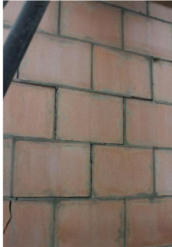
(a) Detalle de la falla escalonada en la cara posterior del muro
