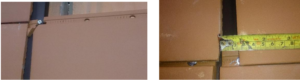
(d) Falla en la conexión de las piezas de fachada al perfil y desplazamiento relativo entre las piezas
