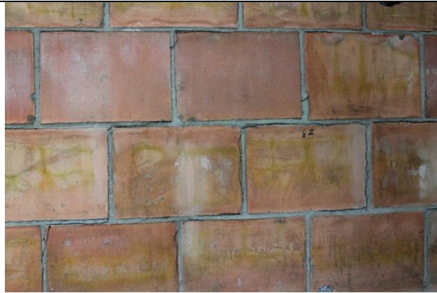
(c) Detalle de la falla escalonada
