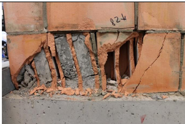
(c) Aplastamiento en la zona de compresión y rotura en las caras del ladrillo
