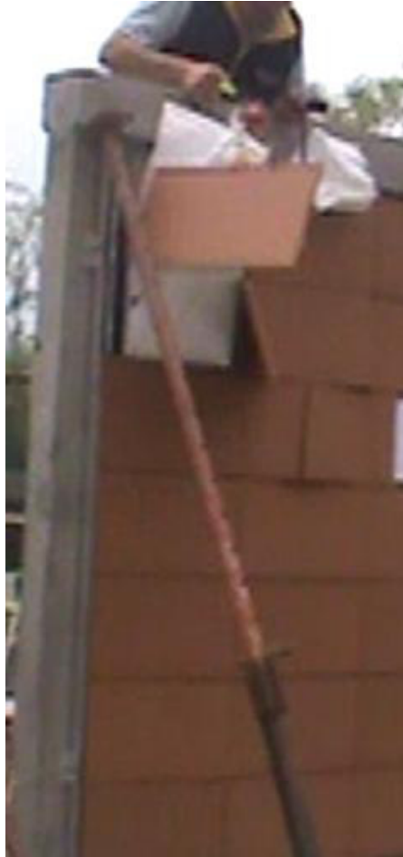
(a) Falla de la fachada adherida
