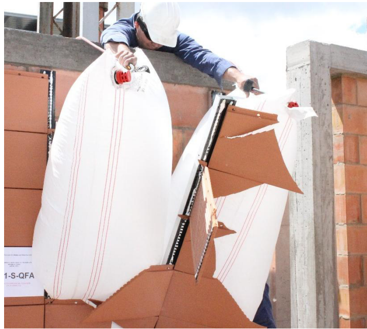
(a) Falla de la fachada adherida
