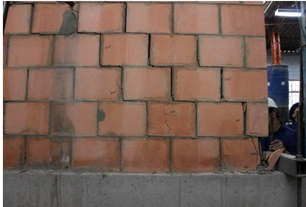
(a) Falla escalonada en la cara posterior del muro
