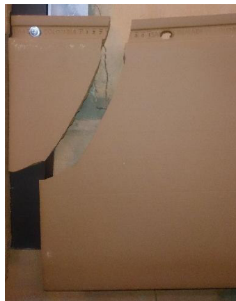
(e) Detalle rotura del elemento de fachada
