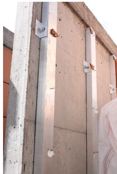
(h) Detalle de la conexión después de la falla de las piezas
