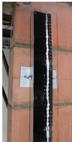
(b) Detalle de discontinuidades del adhesivo de sika
