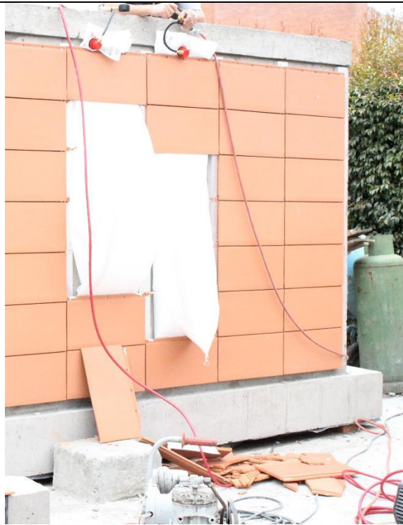
(a) Falla de la fachada con tornillo
