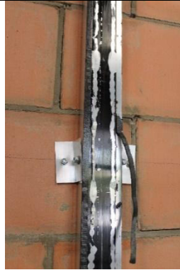
(c) Deficiencias de continuidad del adhesivo
