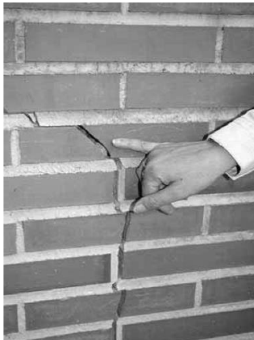
Fotografía 1-6 Grieta en muro no estructural
