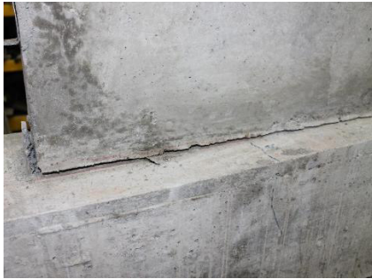
(b) Detalle de la falla en el muro
