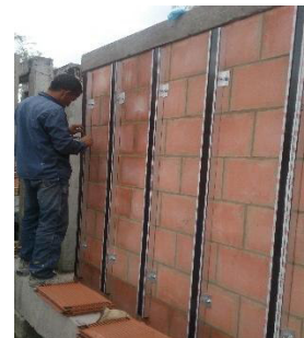
(c) Se aplica el Sika Primer 206 en los perfiles y se coloca la cinta adhesiva espaciadora, de fijación.
