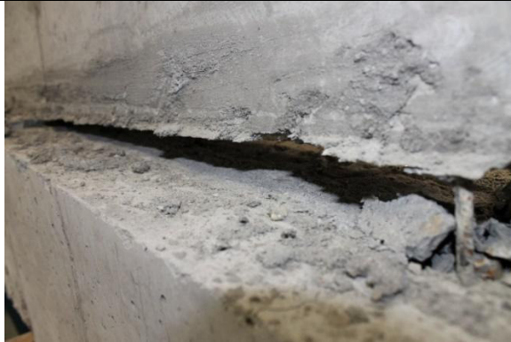
(b) Detalle falla del concreto en la base del muro
