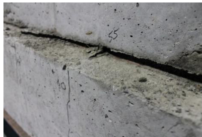
(b) Detalle de desprendimiento de la base del muro
