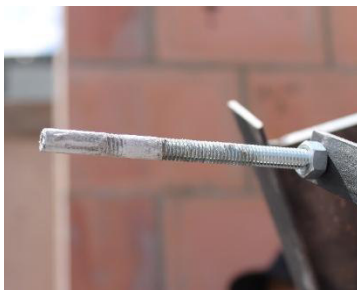
(e) Problema de instalación del anclaje
