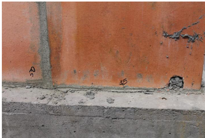
(d) Fisuras en la viga de soporte y en la unión con el muro
