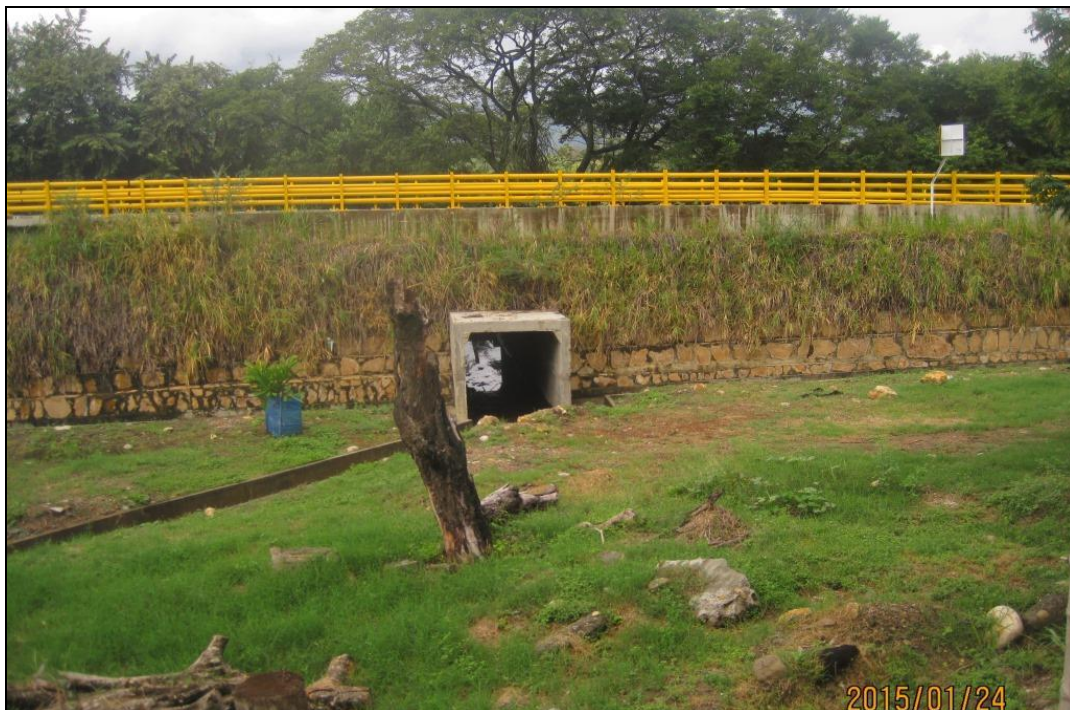
Figura 1. Alcantarilla cajón. Fuente: Propia. Tomada en el approche del Puente Antonio Nariño de la vía Aguas de Dios – Tocaima, Departamento de Cundinamarca.
