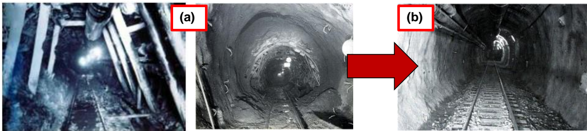
Figura 10-4. Túnel Palacio-Rioblanco, a) Proceso de rehabilitación; b) Después de rehabilitado el túnel. Fuente: (Gutiérrez R., 2015)
