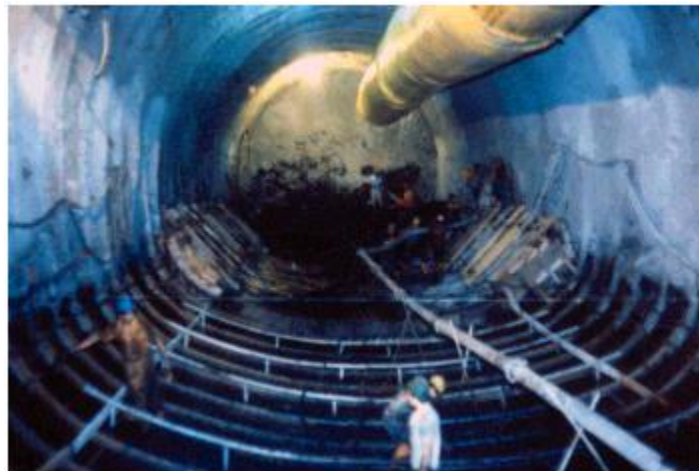
Figura 9-7. Detalles de una sección con solera curva – Túnel de Fuga del proyecto hidroeléctrico Guavio. Fuente: (Marulanda Posada et al., 2008)
