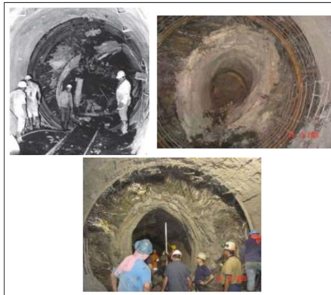
Figura 10-2. Zonas afectadas por grandes empujes (squeezing). Fuente: (Gutiérrez R., 2015)
