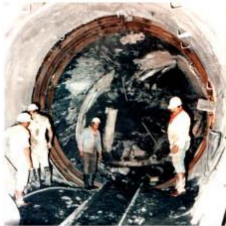
Figura 10-10. Túnel Yacanmbú-Quibor. Restos de un máquina de perforación de túneles atrapados por altas compresiones del túnel. Fuente: (Evert Hoek, 2001)
