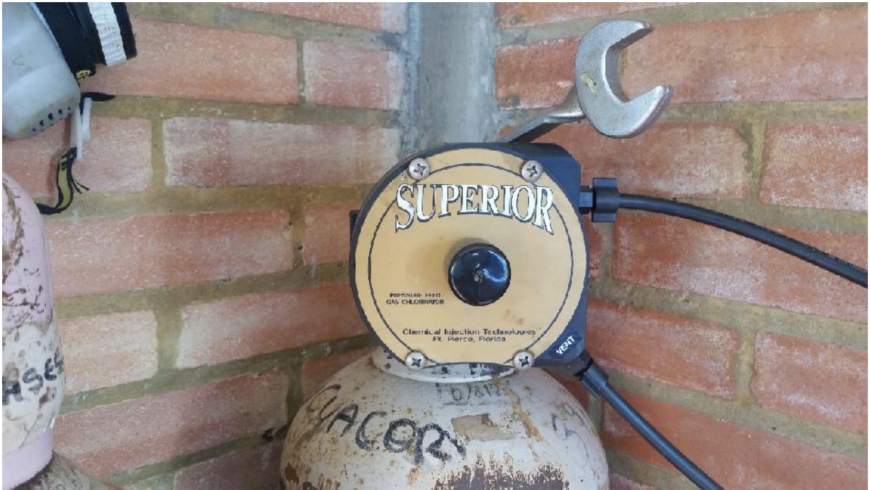
Fotografía 20. Contenedor vertical de cloro gaseoso.
