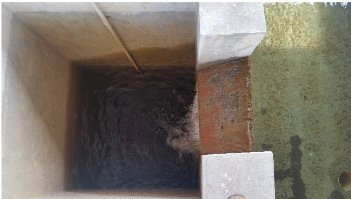
Fotografía 13 Paso del Agua de los sedimentadores a filtros lentos - flujo descendente en arena
