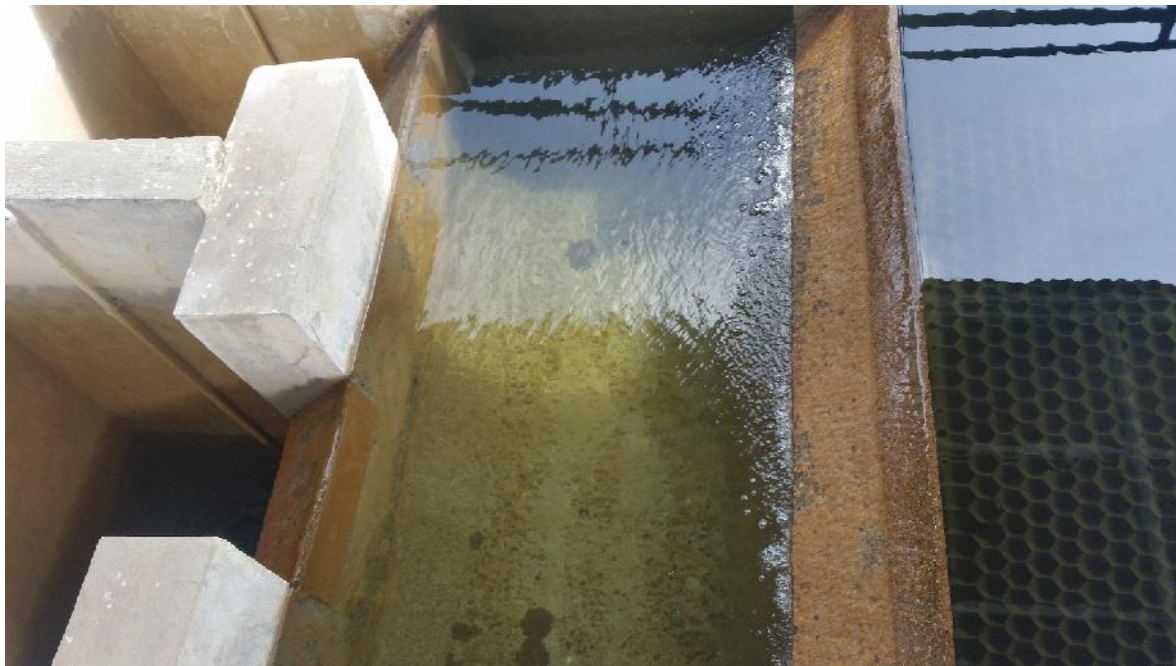
Fotografía 12 Paso del Agua de los sedimentadores a filtros lentos - flujo descendente en arena
