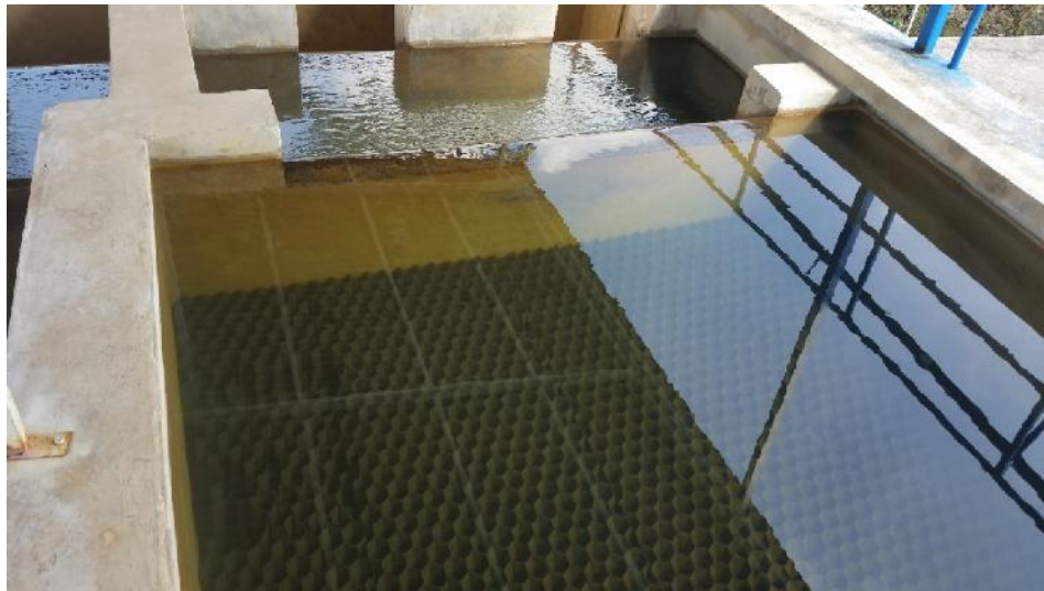
Fotografía 11 Vista posterior de Sedimentadores se observan los paneles hexagonales de flujo ascendente, al fondo filtros rápidos.
