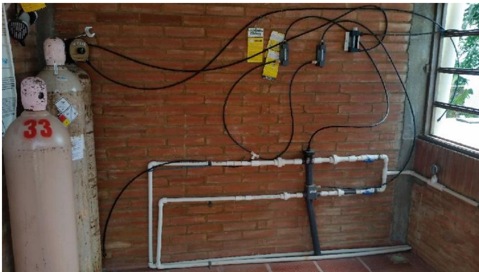
Fotografía 19 Sistema de Cloración dentro de la Caseta para tal Fin.
