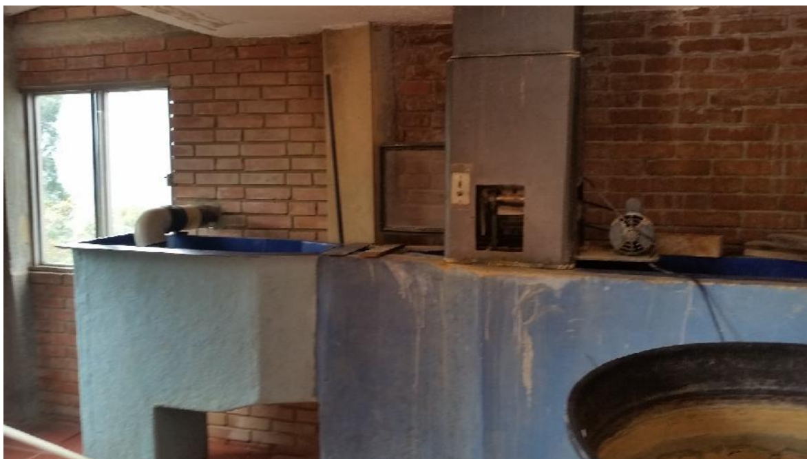
Fotografía 6 Cámara de entrada Canaleta Parshall
