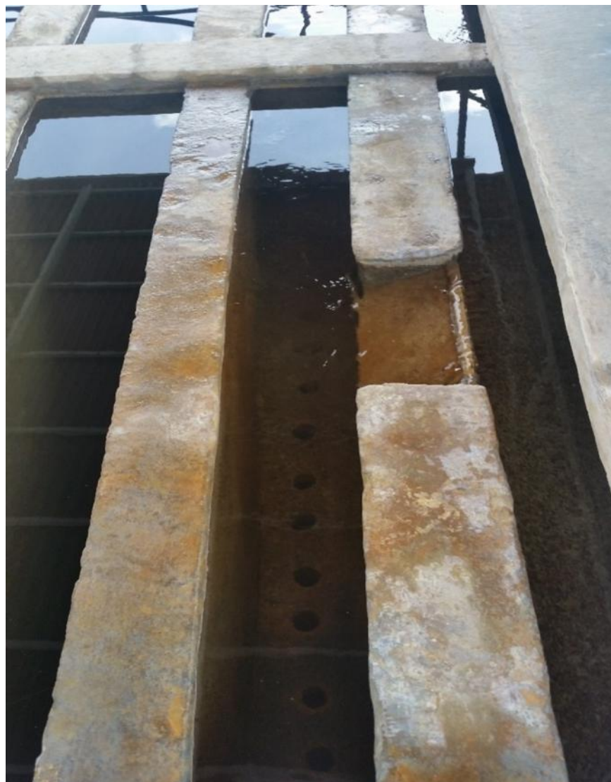
Fotografía 9 Canal de ingreso del agua a Filtros de Alta Tasa
