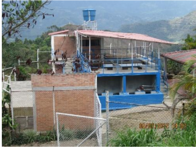
Fotografía 3 Planta de tratamiento de Agua Potable Fuente: Propia, 2015.
