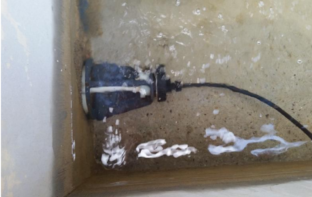
Fotografía 18 Inserción de Cloro gaseoso al efluente de la Planta, previo al almacenamiento.
