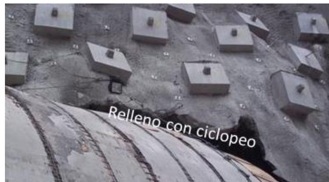
Figura 177 Desprendimientos durante la construcción de un portal sesgado.
