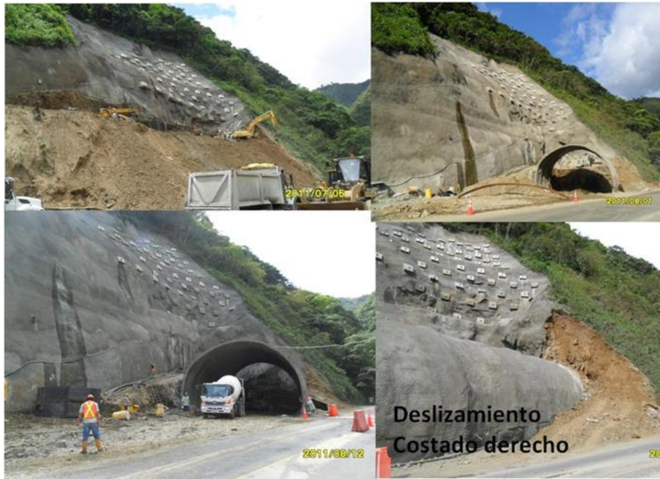
Figura 36 Inestabilidades al inicio de la excavación subterránea costado derecho.
