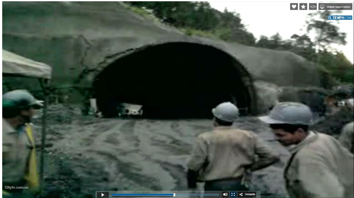
Figura 85 Etapa 2 Desprendimientos de concreto neumático y grandes deformaciones.
