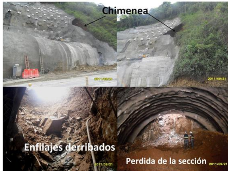
Figura 37 Colapso de bóveda y formación de chimenea
