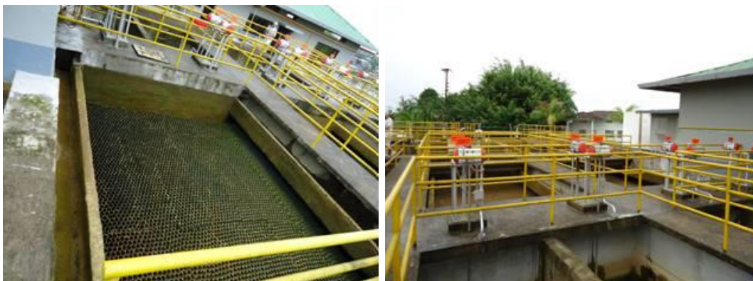
Figura 1-6. Sedimentador Planta La Loma
