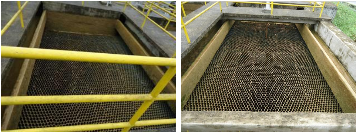
Figura 1-9. Zona de Salida del Sedimentador
