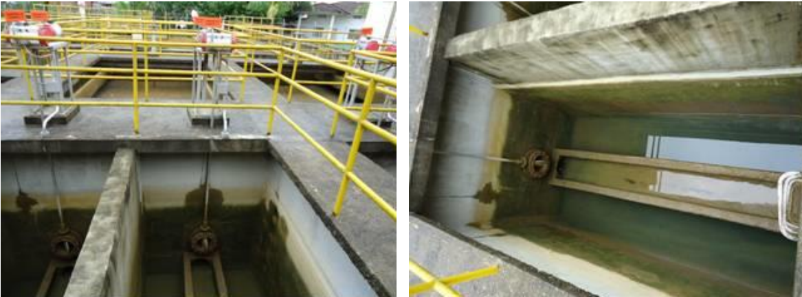
Figura 1-10. Ingreso a los Filtros Rápidos
