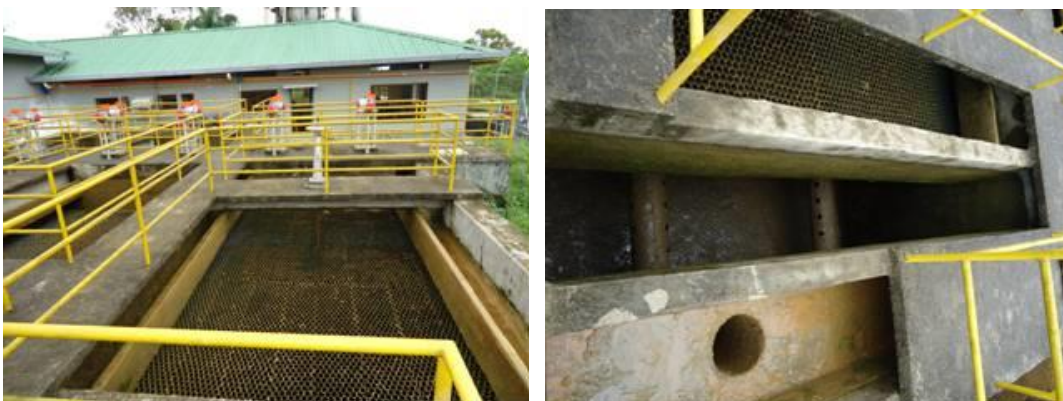
Figura 1-7. Orificio del paso de Agua entre el Floculador y el Sedimentador
