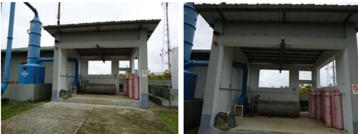
Figura 1-11. Desinfección del Agua Planta La Loma
