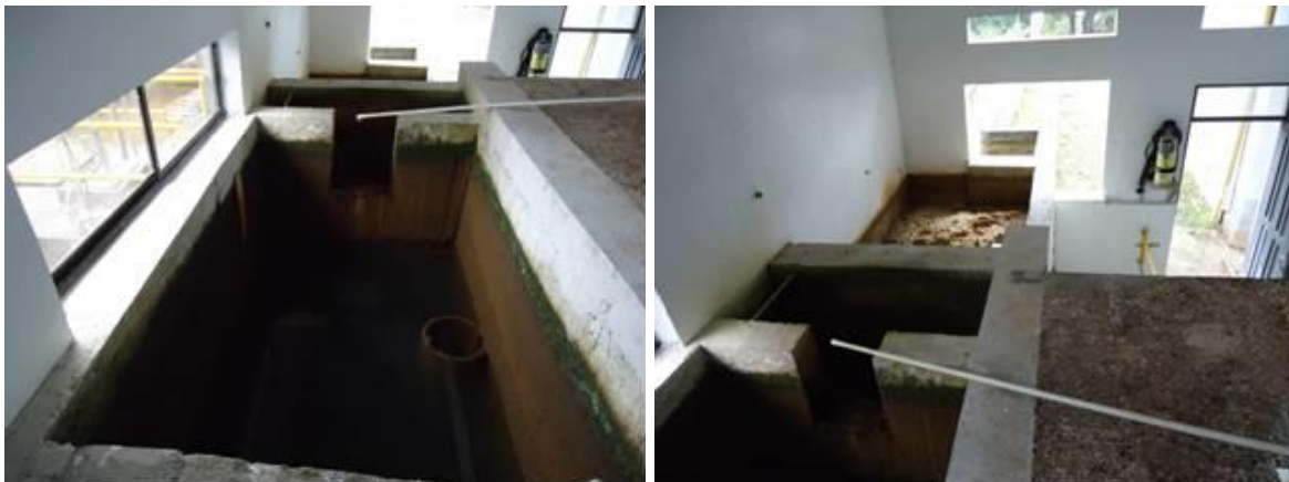
Figura 1-3. Cámara de Llegada y Adición del Coagulante
