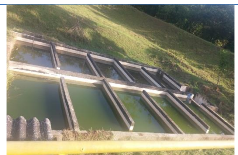
Ilustración 50. Tanque de Contacto
