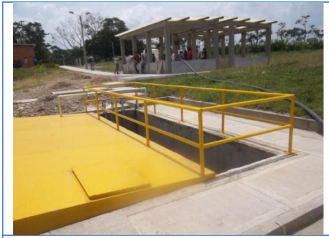
Figura 20. Lecho de secado de lodos
