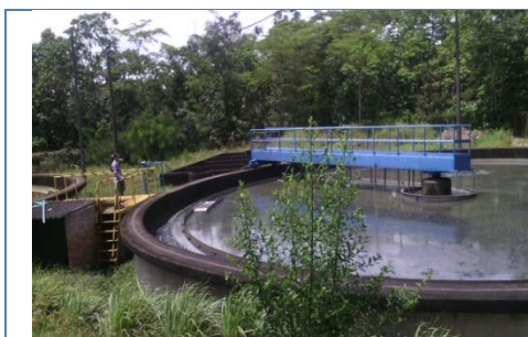
Figura 9. Sedimentador secundario PTAR Acacias
