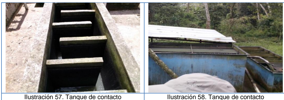
Ilustración 57. Tanque de contacto
