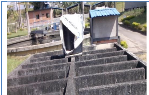
Figura 29. Tanque de Contacto con cloro
