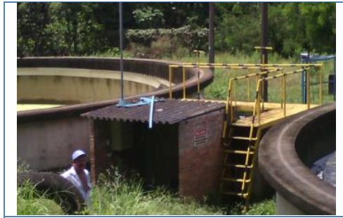
Figura 11. Pozo bombeo de Lodos
