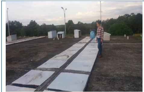
Ilustración 39. Tanque de sedimentación
