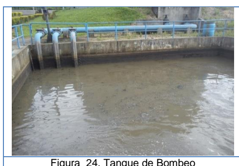
Figura 24. Tanque de Bombeo
