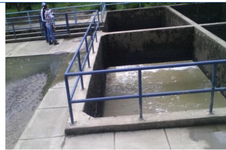
Ilustración 4. Tanque de Bombeo PTAR Acacias
