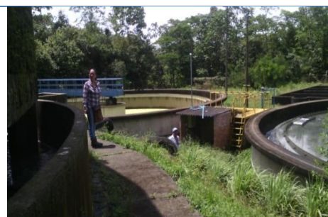
Figura 10. Sedimentador secundario PTAR Acacias
