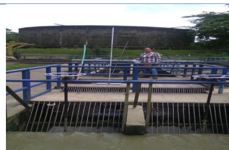
Figura 7. Rejillas de la PTAR
