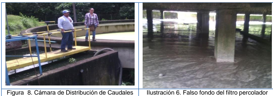
Figura 8. Cámara de Distribución de Caudales
