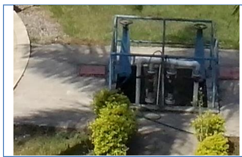
Figura 28. Bombeo de lodos
