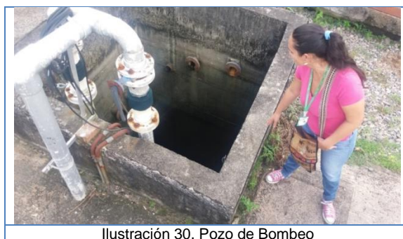
Ilustración 30. Pozo de Bombeo
