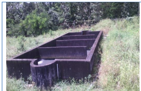
Ilustración 7. Tanque de contacto con cloro
