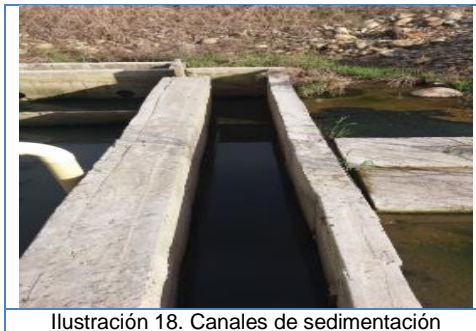
Ilustración 18. Canales de sedimentación
