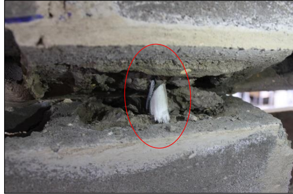
Foto 26 Rotura en Barras FRP
