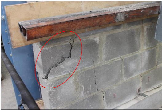
Foto 23 Aplastamiento en la Mampostería
