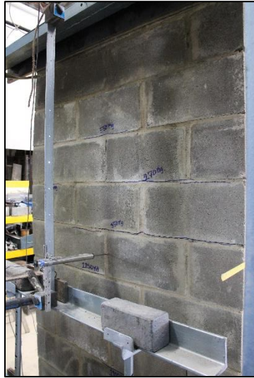
Foto 39 Fisuras Según Cargas
