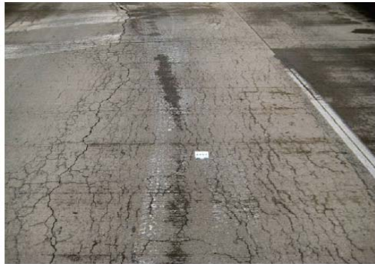
Figura 1-10 (a) Mapa de grietas de un puente de 30 años de edad (b) Grietas alineadas en una columna afectada RAS (c) Patrón de grietas asociada al RAS.
