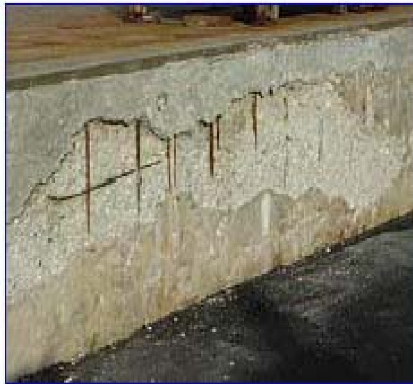
Figura 1-11 (a) Movimiento relativo de estructura de puente afectado por RAS (b) Expansión con desprendimiento severo (c) Descascaramiento asociado a RAS.
