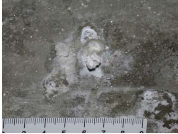
Figura 1-12 Exudación en concreto observado dentro de una galería de una presa. (Russell, 1983; y Farny Kosmatka., 1997; Fournier et al, 2004).
