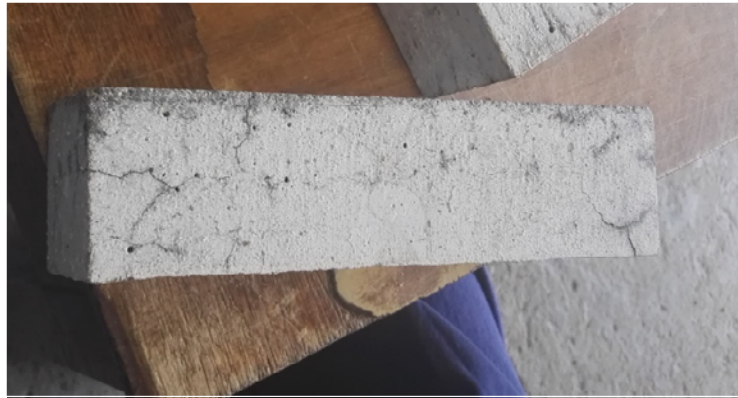
Figura 5-20 Fisuración de viga de mortero debido a RAS.
