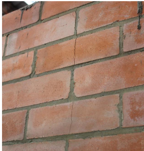
3.) Fisuras en la cara de compresión del muro M2-G
