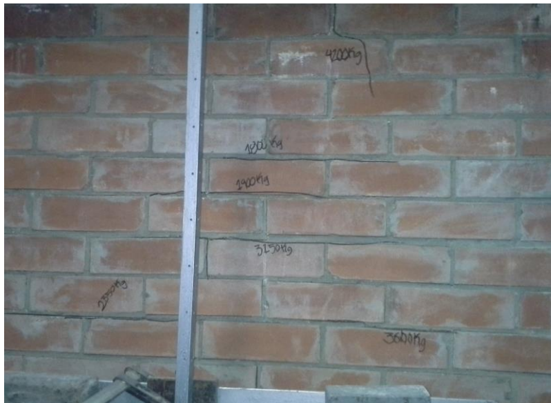
2.) Fisuras en la cara de tensión del muro M15-S.
