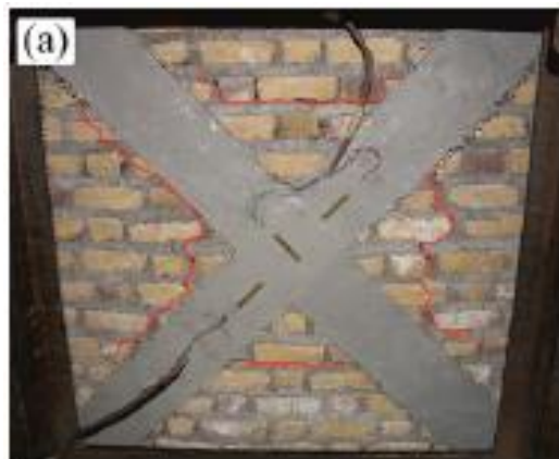
Figura 2-3 Esquema de reforzamiento del muro con FRP. Tomado: Razieh Sistani Nezhad, Mohammad Z. Kabir. 2016.
