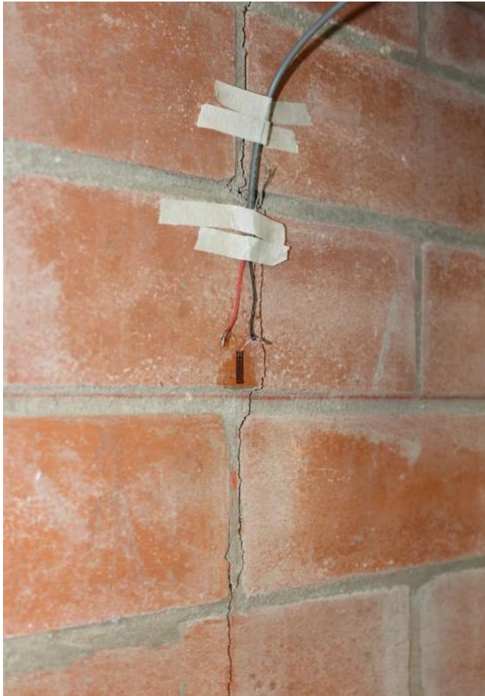
2.) Fisuras en la cara de compresión del muro M13-C.
