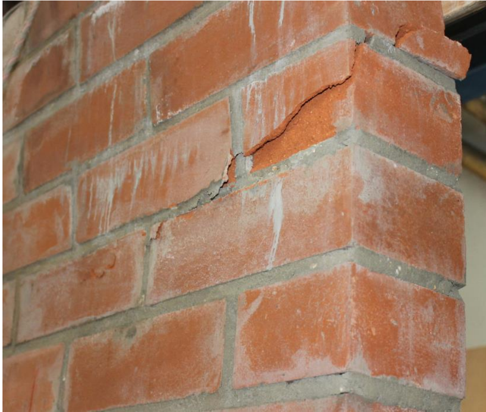
3.) Falla del muro M8-C
