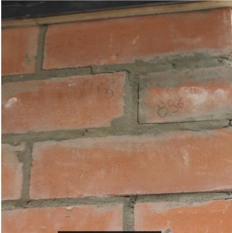
1.) Fisuras en la cara de tensión del muro M9-C
