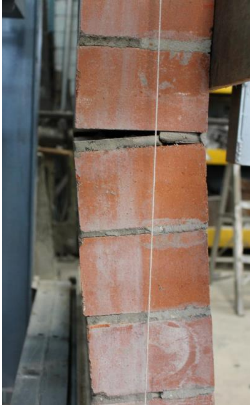
2.) Falla por separación del mortero de pega con el ladrillo del muro M12-C.vista de perfil
