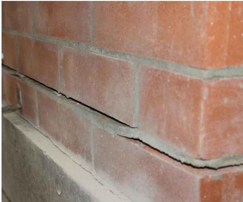
2.) Falla por separación entre ladrillos
