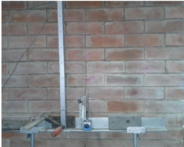
2.) Fisuras en la cara de tensión del muro M16-S.
