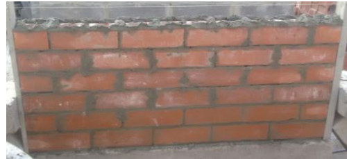
4.) Colocación del mortero de pega en las hiladas de los ladrillos de mampostería.
