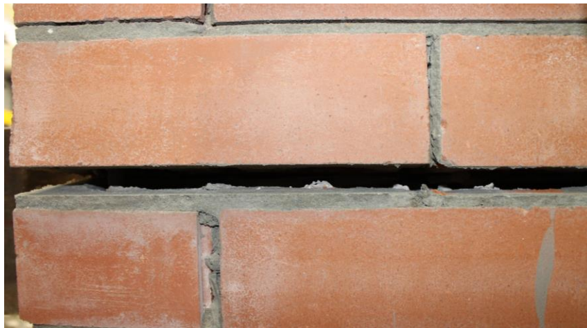
2.) Falla del muro M3-G por separación de los ladrillos
