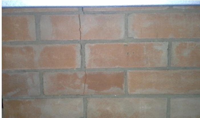
1.) Fisuras en la cara de tensión del muro M4-G
