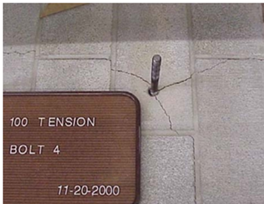
Figura 3-11: Fisuración en la mampostería Fuente: (Fabrello, Pollock, McLean, & Young, pág. 8)
