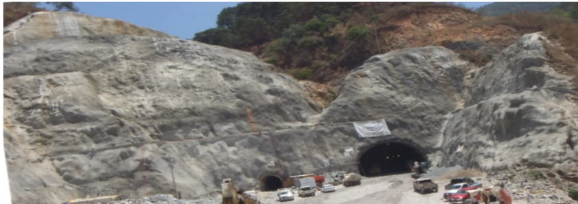
Figura 6. Excavación y cortes a cielo abierto en zona de portal de Túnel. Fuente: (AMITOS & Guzman, Túneles Carreteros Diseño, Construcción y Supervisión, 2012). Túneles Carreteros Diseño, Construcción y Supervisión.
