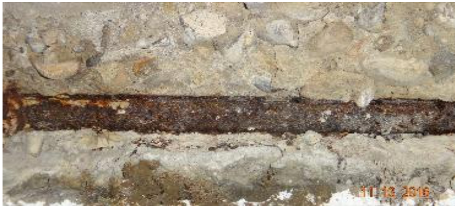
Figura 112. Daños por filtración de agua en placa de concreto, corrosión de acero instalado como refuerzo de la placa en un muro de estabilización.
