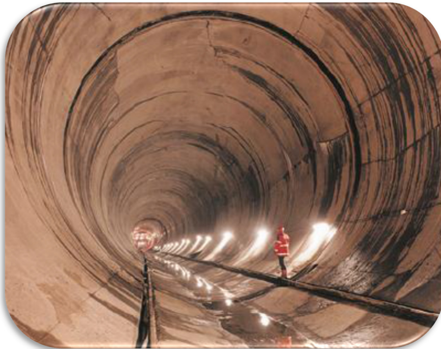
Figura 16. Proyecto Hallansas, Suecia, revestimiento en dovelas y geomembranas. Fuente: (ITACET, 2012). Manejo de Agua en Túneles.
