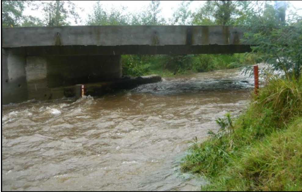
Sección estable Ubicada debajo de un puente – Fotografía tomada de aguas abajo hacia aguas arriba.
